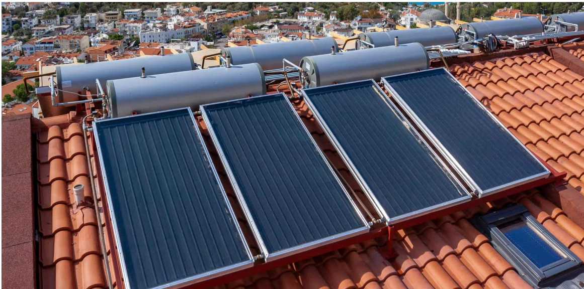
Figura 5 - Placas solares térmicas instaladas sobre el tejado de una vivienda [3]
