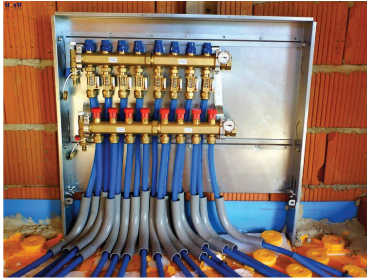
Figura 1-31 Tubos colectores que incorporan válvulas de usuarios y detentor.
