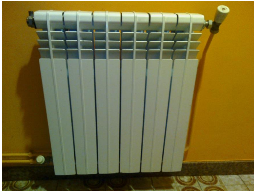
Ilustración 4-11 Radiadores de aluminio instalado de 6 elementos
