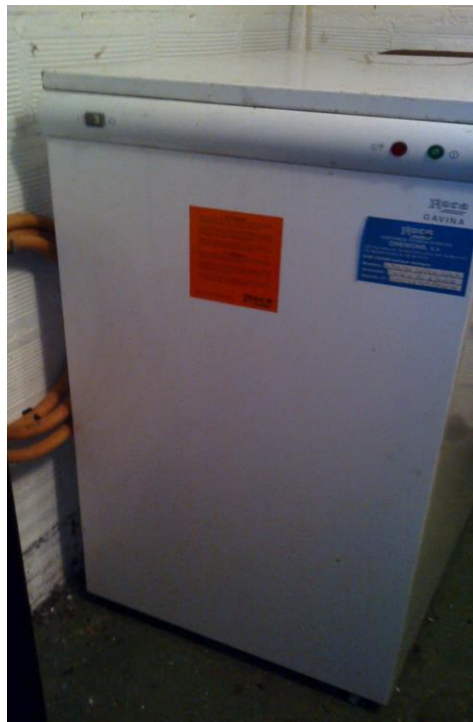
Ilustración 4-9 Caldera de gasóleo instalada
