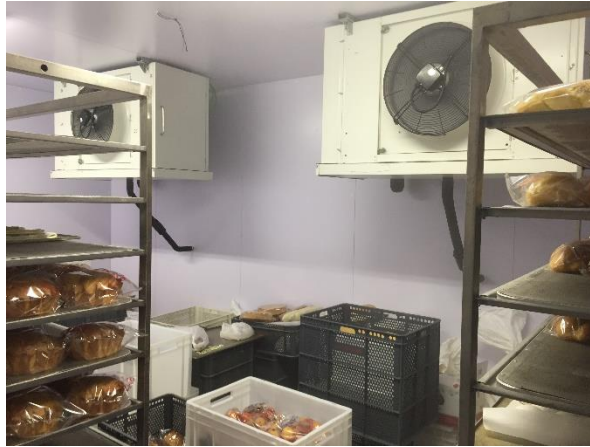
Imagen 19. Cámara frigorífica. Elaboración propia.
