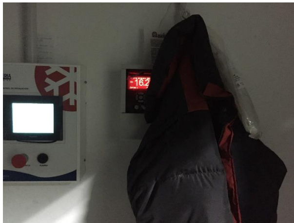
Imagen 20. Cuadro de mandos de la cámara frigorífica. Elaboración propia.
