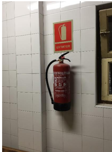
Imagen 29. Extintor de polvo con su debida señalización dentro del obrador. Elaboración propia.
