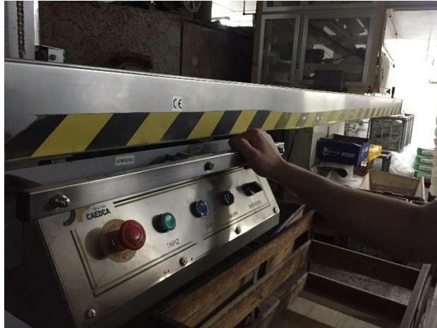
Imagen 9. Cuadro de mandos del cargador puente. Elaboración propia.
