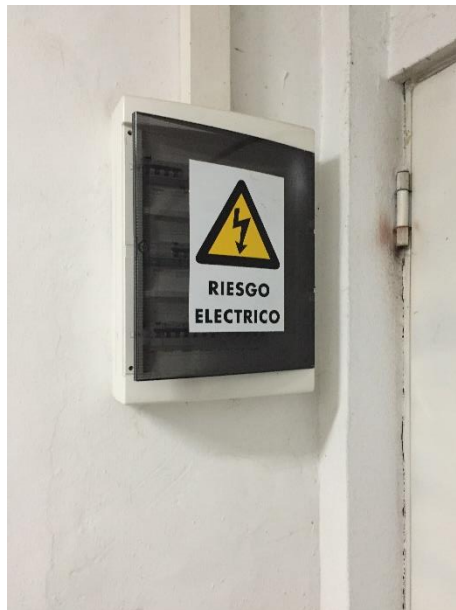
Imagen 33. Señal indicando la presencia de un cuadro eléctrico con la correspondiente señal de riesgo eléctrico, en este caso en el almacén. Elaboración propia.
