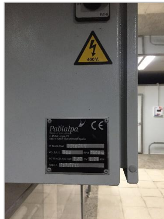
Imagen 31. Señal de aviso de descarga eléctrica en el tren de laboreo. Elaboración propia.
