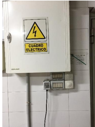
Imagen 30. Cuadro eléctrico debidamente señalizado. Elaboración propia.
