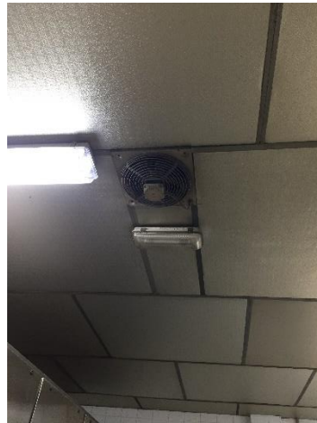
Imagen 27. Extractor de aire en el techo del obrador. Elaboración propia.
