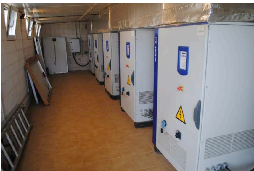
Figura 6.2-1. Sala de inversores
