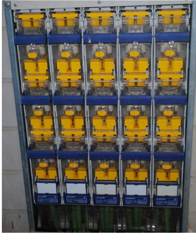
Figura 6.3-3. Fusibles alta tensión
