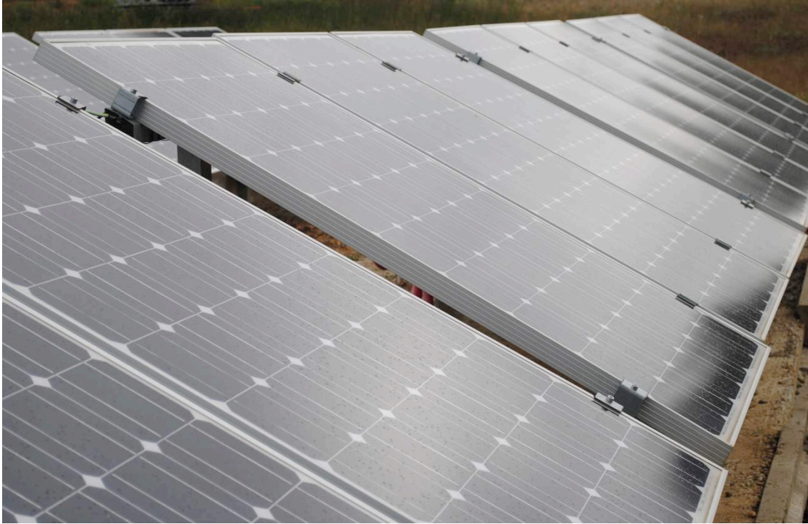
Figura 6.1-4. Panel fotovoltaico inspeccionado
