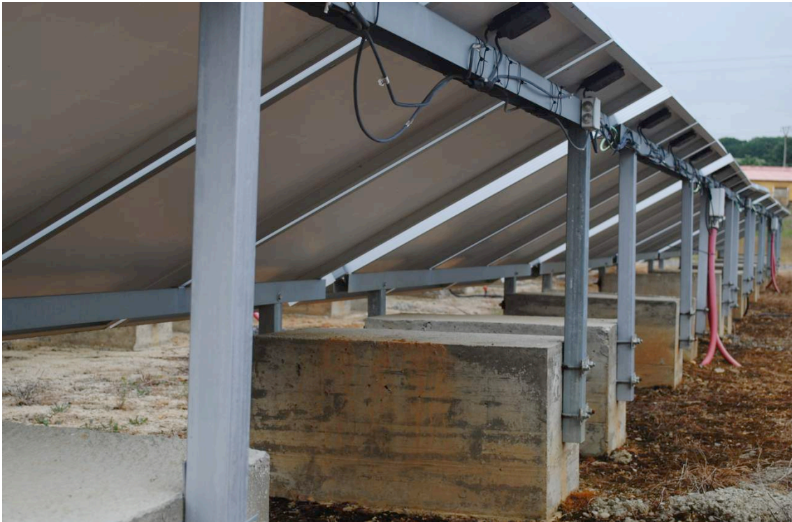
Figura 6.1-2. Estructura paneles fotovoltaicos
