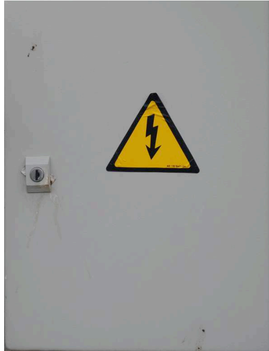
Figura 6.7-4. Identificación de riesgo eléctrico
