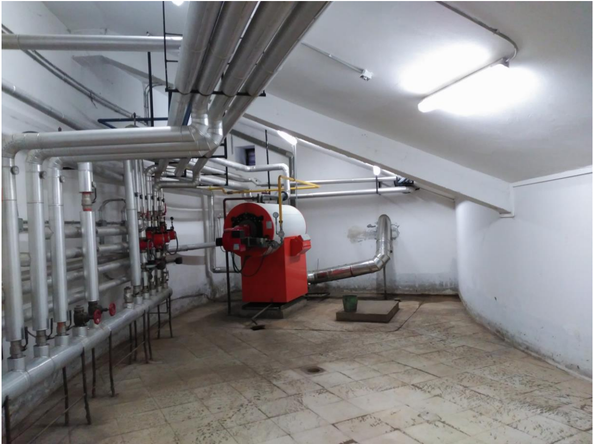
Figura 6-8 Sala de calderas de la Escuela de Minas.
