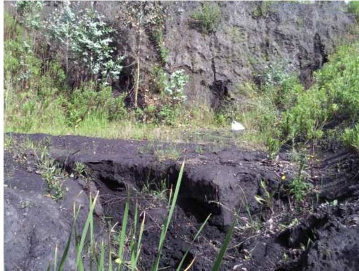
Imagen 50.- Afloramiento de finos de carbón en la base de la escombrera
