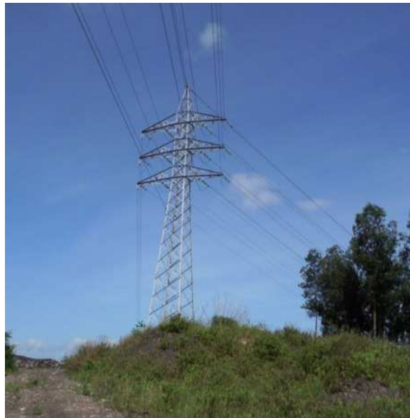
Imagen 48.- Detalle del apoyo de la línea eléctrica en la escombrera.
