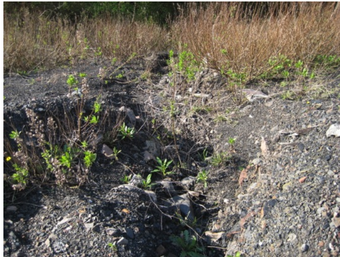
Imagen 45.- Grietas en la escombrera
