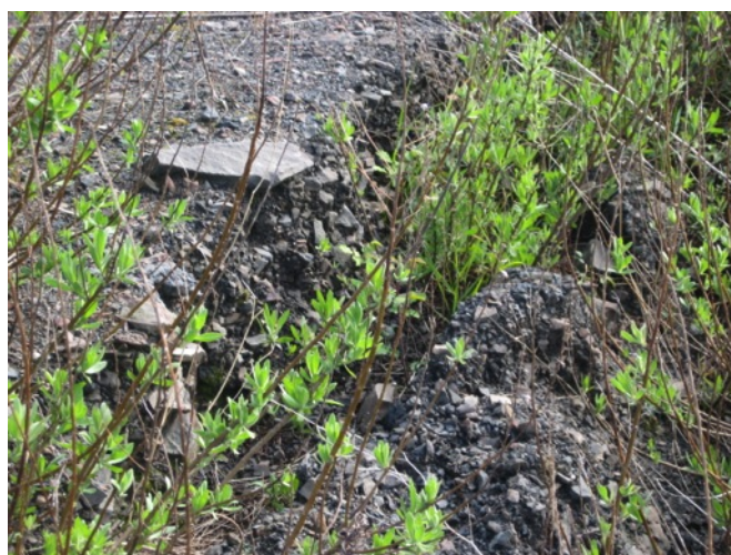
Imagen 52.- Grietas en la superficie de la escombrera
