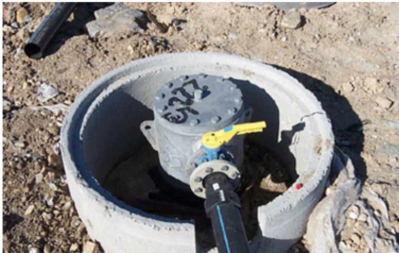
Figura 26. Detalle de captador de biogas instalado en vertedero de RSU clausurado.
