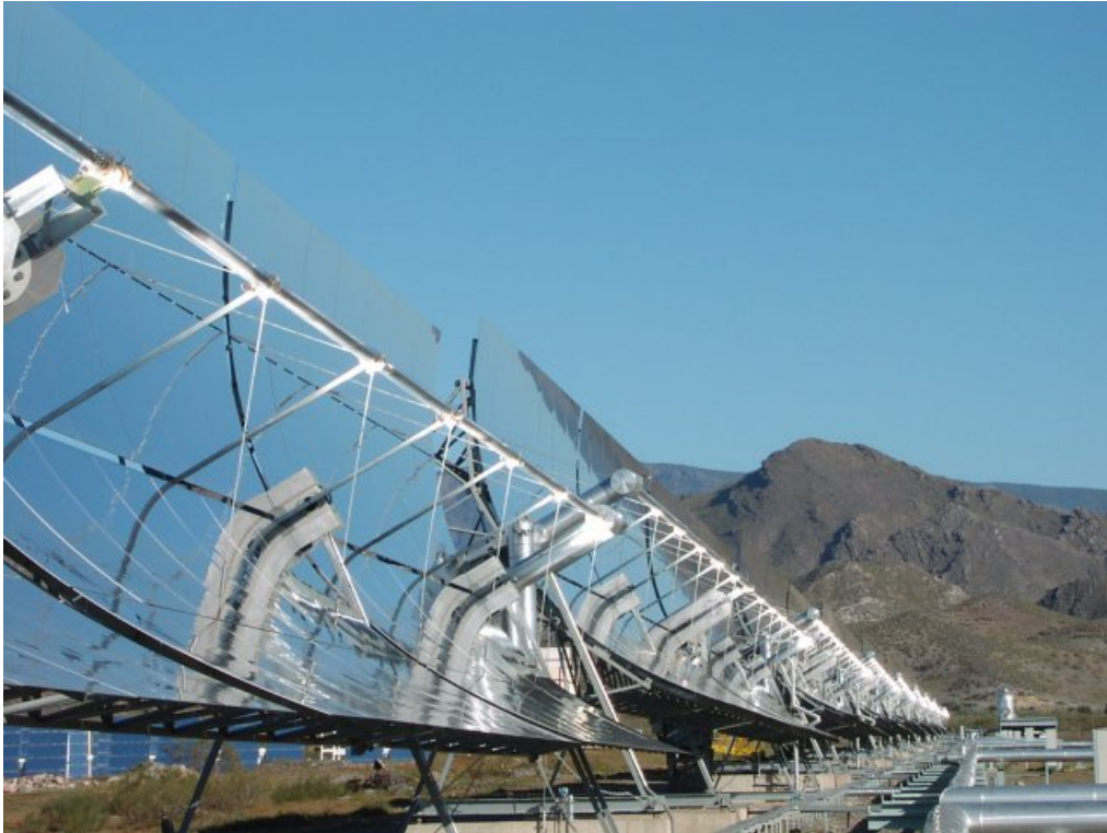
Figura 21. Colectores cilindro parabólicos.
