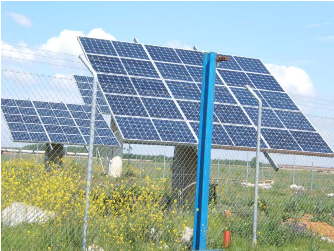
Figura 25. Paneles fotovoltaicos situados sobre el terreno.
