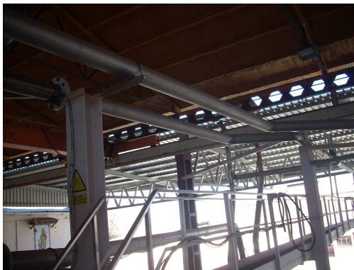
Figura N° 9: conjunto de tuberías de transporte Fuente: Propia
