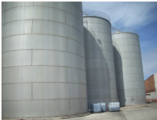
Figura N°20: Depósitos de almacenamiento Fuente: Propia
