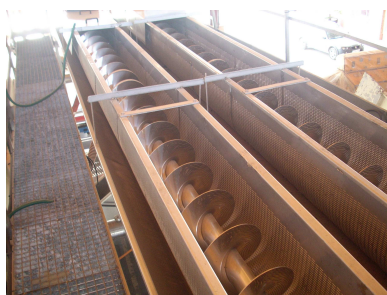
Figura N° 10: Sinfines recepción pasta Fuente: Propia
