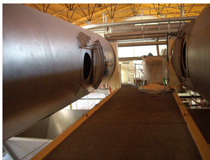
Figura N°14: Prensas neumáticas Fuente: Propia
