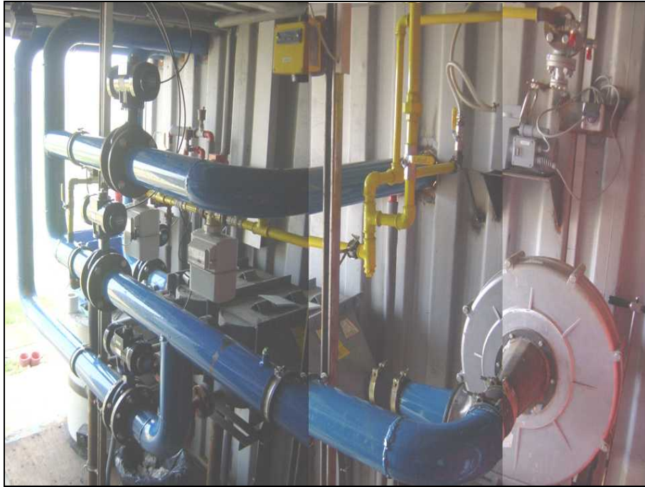
Figura 4.2. Vista del interior del contenedor de control.
