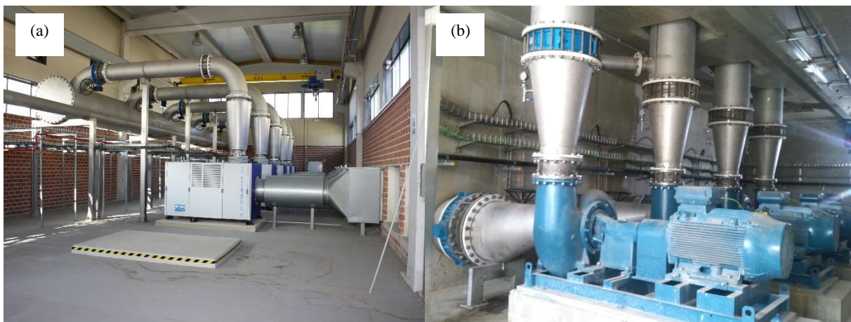
Figura 3.9. Equipamiento del colector general de los escenarios 2, 3 y 4. a) Turbosoplantes de levitación magnética. b) Bombas de recirculación de fangos biológicos (EDAR, 2016).
