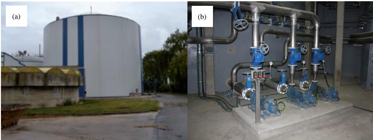
Figura 4.5. Digestión anaerobia. a) Vista exterior de un digestor. b) Bombas de recirculación de fangos (EDAR, 2016).
