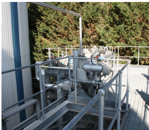
Figura 6.19. Intercambiador de gases de proceso.
