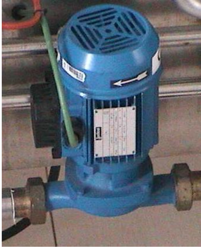
Ilustración 4.4 Bomba de recirculación
