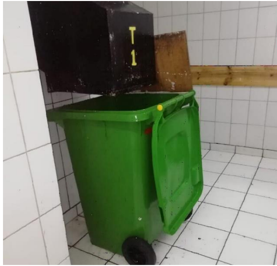
Figura 1.6 Final conducto shaft. (Fuente: Fin de plagas, página sobre limpieza de shafts, 2020).
