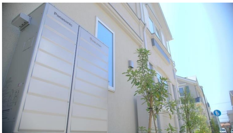
Figura 3. 5. Instalación de dispositivo H2 KIBOU en el exterior de la vivienda. [38]
