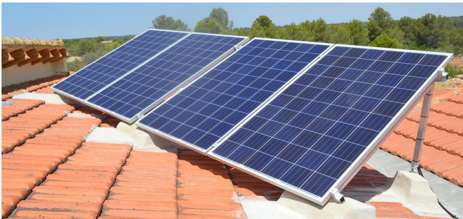
Figura 3. 3. Placas solares instaladas en el tejado del hogar. [36]
