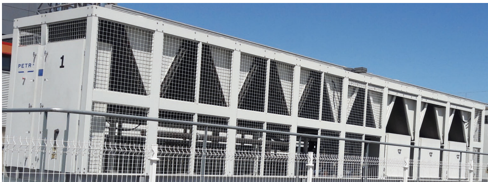
Figura 6.13. Equipo de producción de frío del Hospital de León
