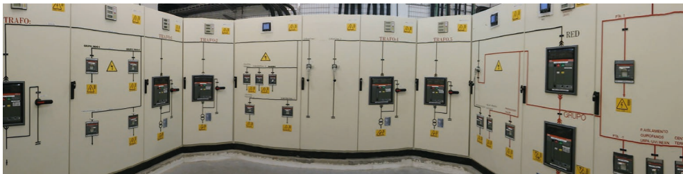
Figura 6.19. Equipamiento submetering del Hospital de León
