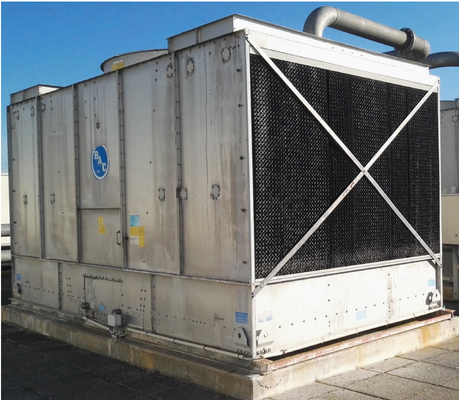
Figura 6.16. Equipos HVAC del Hospital de León
