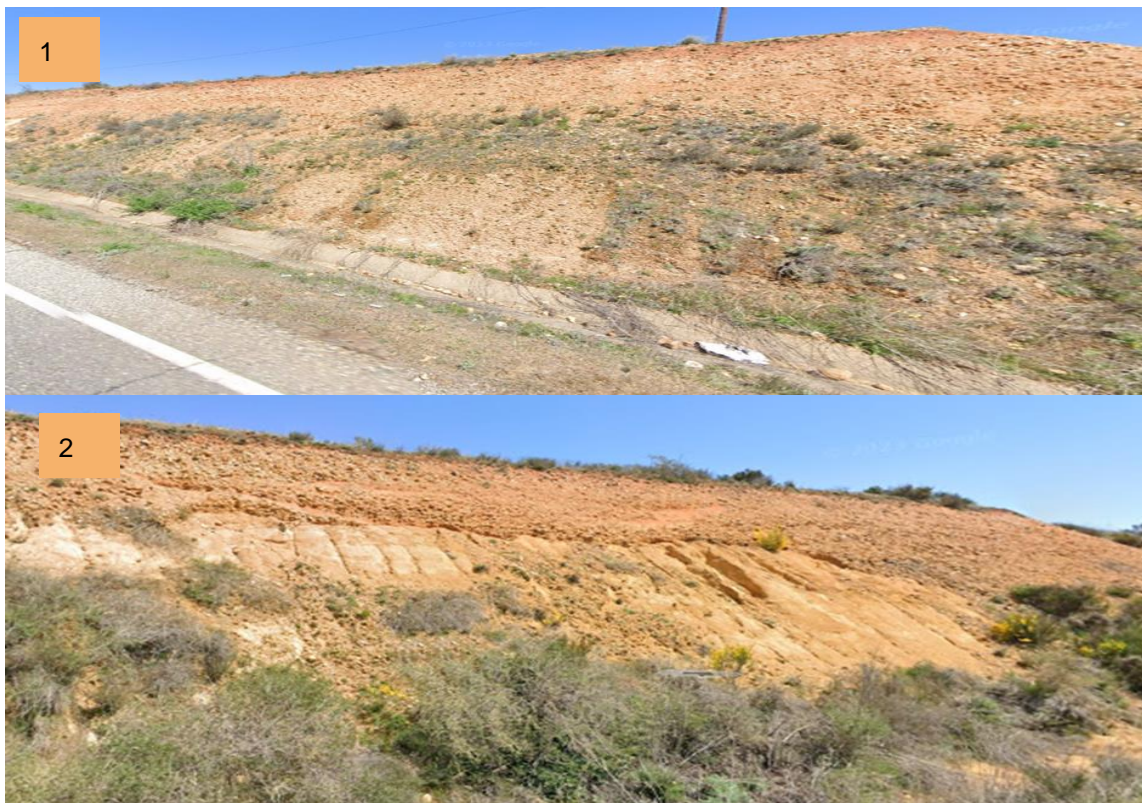
Figura 2. Fotografías de los taludes de carretera que corresponden a la zona de estudio. (1) Foto general del talud (2) detalle que muestra los efectos del agua de escorrentía.
