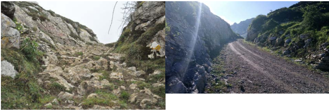
Figura 5.18_ Detalle del paso del Boquerón antes y después de la construcción de la pista forestal.
