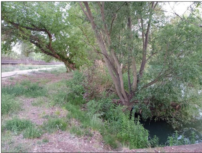
Figura A.2.11. Fotografía de la orilla en la margen izquierda (orientación aguas abajo) de la parte inferior del tramo. Se puede distinguir el efecto de deslizamiento que producirá, junto con la erosión de la orilla, la caída de los árboles hacia el cauce.
