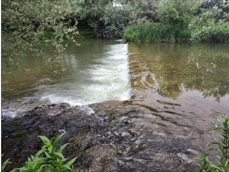
Figura A.2.5. Fotografía de una de las 14 traviesas dispuesta en el tramo de estudio. Esta imagen corresponde a una de las que se encuentran en la parte inferior, después del puente de los Leones. Se puede distinguir como se produce una superficie remansada en la parte superior. (Fuente: Elaboración propia).
