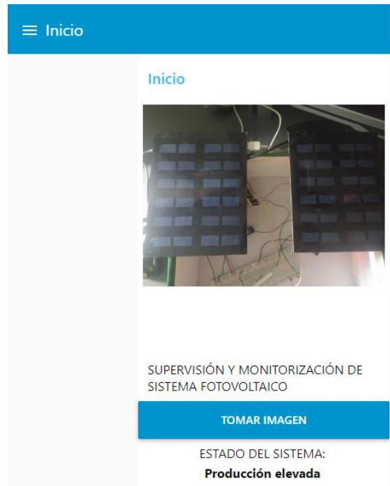
Ilustración Anexo 3.3 Panel de Inicio durante condiciones normales de trabajo Fuente: Propia
