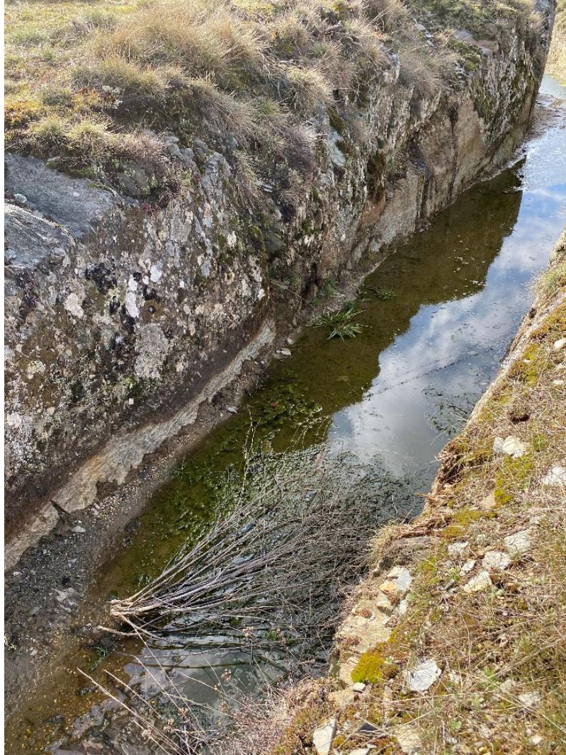
Figura 4.2 Picado en el canal de transporte de agua.
