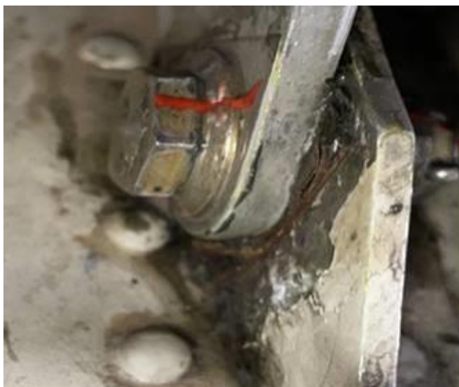
Figura 5.1: Corrosión en el soporte delantero izquierdo de la BTI. (Fuente: Elaboración propia)
