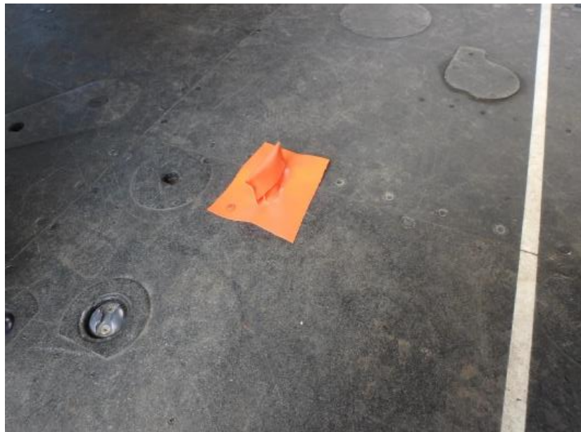
Figura E.1: Posición cerrada del acceso para el anclaje de camillas. Impide el paso de agua y facilita la operación reduciendo la zona con relieve. (Fuente: [29])
