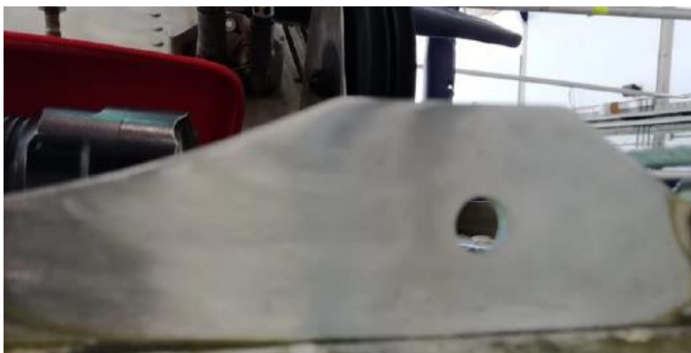
Figura 5.5: Soporte visto desde la parte delantera izquierda de la BTI tras sanear la corrosión. (Fuente: Elaboración propia)
