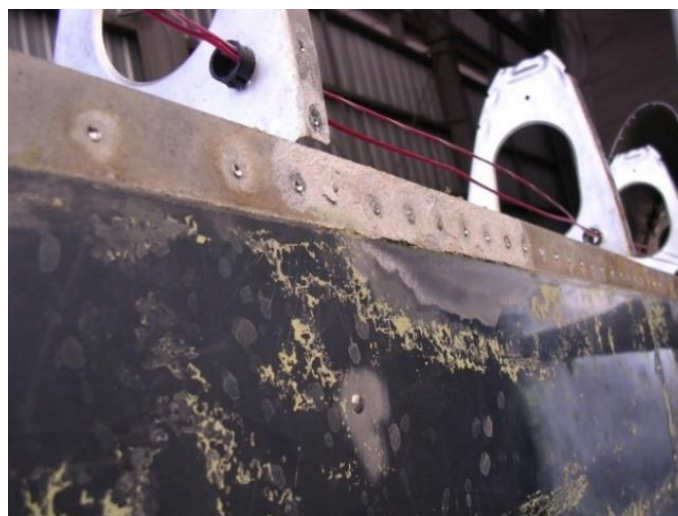
Figura 2.5: Corrosión superficial uniforme.
