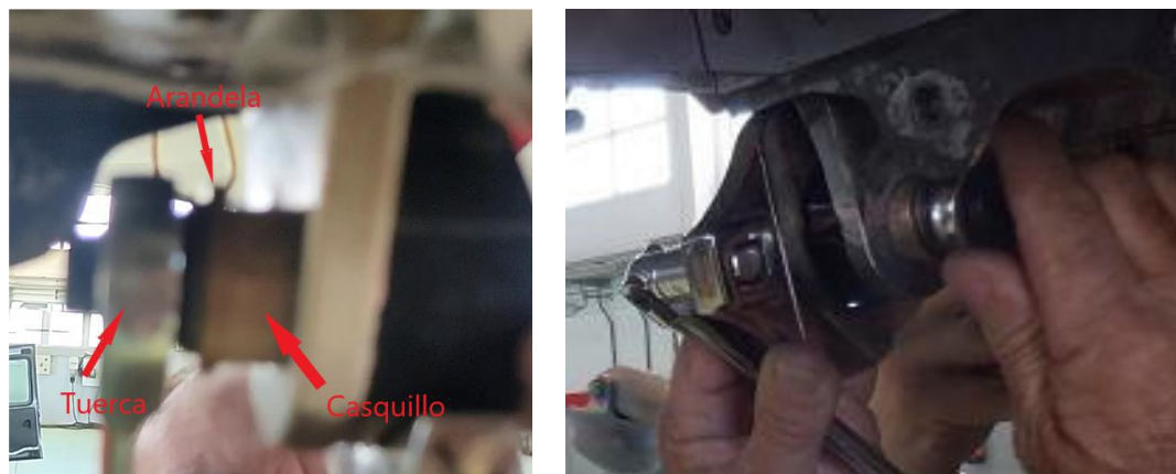
Figura 5.16: Sistema montado. (Fuente: Elaboración propia)
