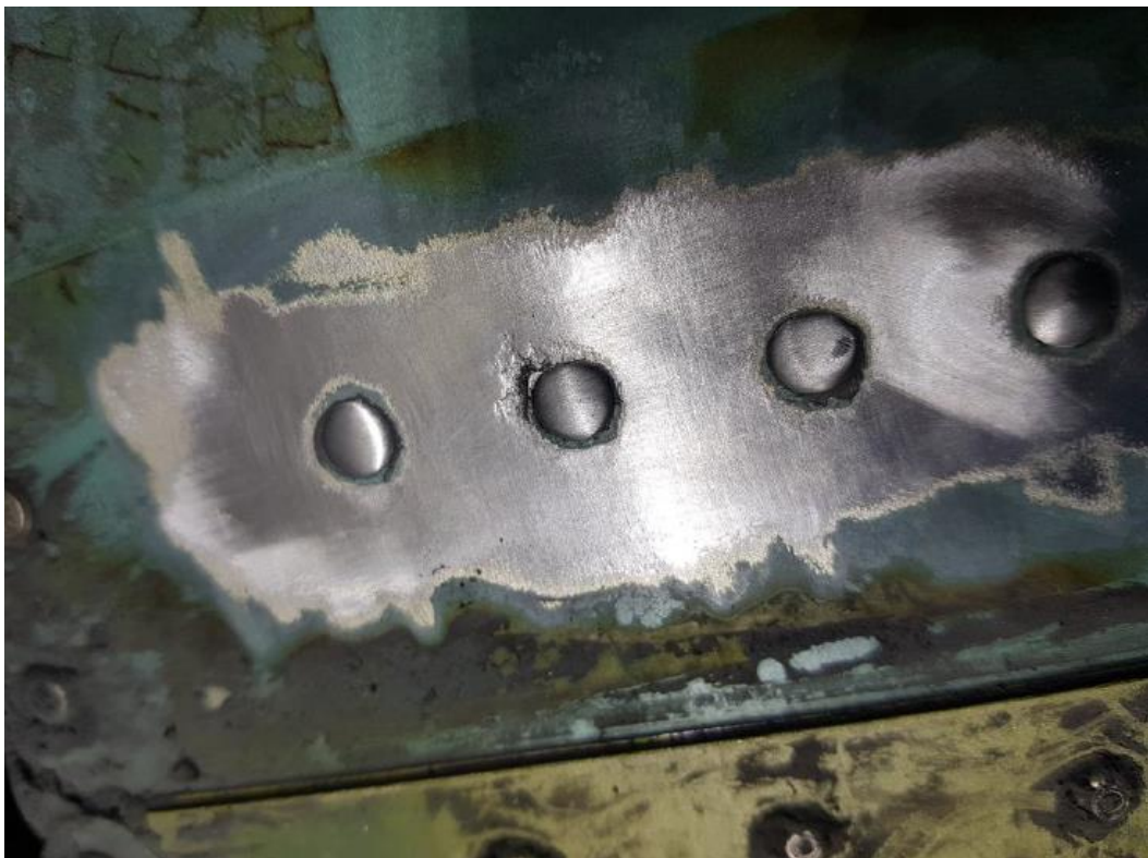
Figura 5.41: Zona 4 decapada. Se observa pitting alrededor de los remaches. (Fuente: Elaboración propia)
