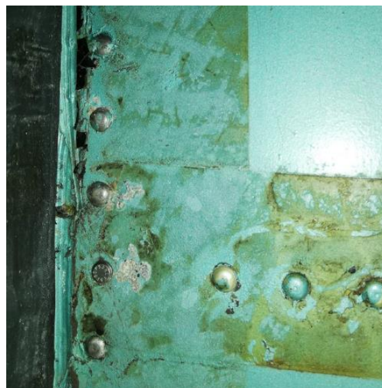
Figura 5.38: Corrosión en la zona 3. (Fuente: Elaboración propia)
