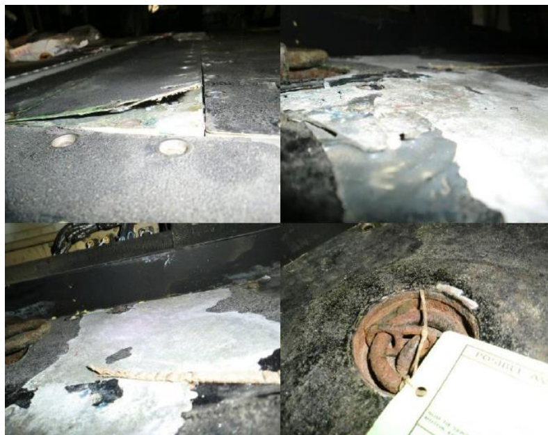
Figura 5.23: Corrosión en los paneles del suelo de la cabina de carga. (Fuente: Elaboración propia)
