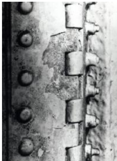
Figura 3.10: Corrosión en una bisagra de piano. (Fuente: [10])
