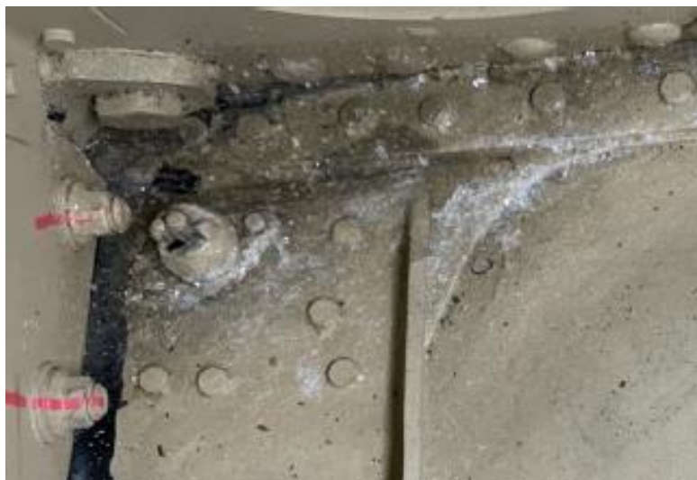
Figura 5.8: Depósito de sal en la estructura bajo el piso en la esquina trasera derecha. (Fuente: Elaboración propia)
