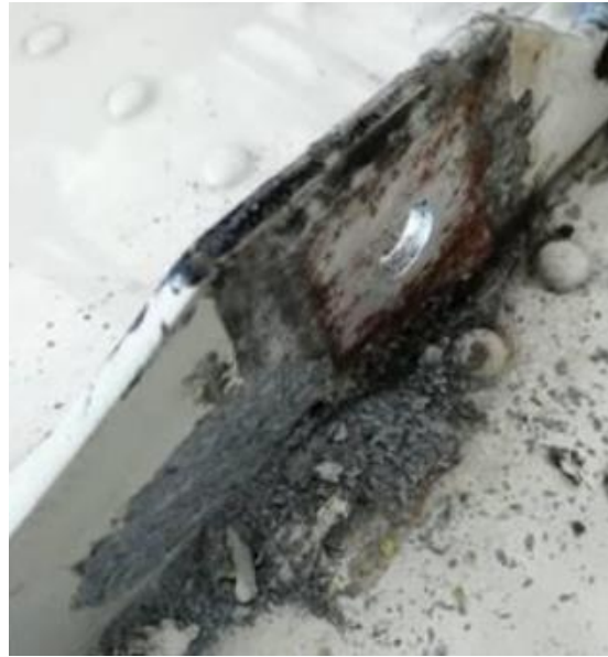
Figura 5.2: Pieza corroída. (Fuente: Elaboración propia)
