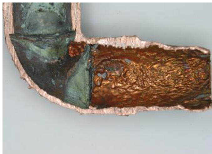
Figura 2.20: Tubería que ha sufrido corrosión por erosión.
