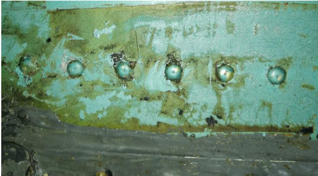
Figura 5.40: Corrosión en la zona 4. (Fuente: Elaboración propia)
