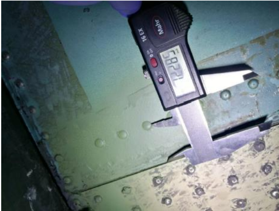
Figura 5.43: Zona 4 saneada y pintada. Medida de la distancia entre la línea de remaches al refuerzo de la zona 1. (Fuente: Elaboración propia)
