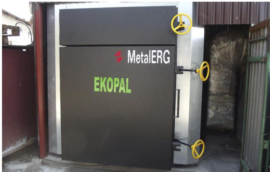
Figura6.33-Caldera Metalerg Ekopal utilizada para el ACS
