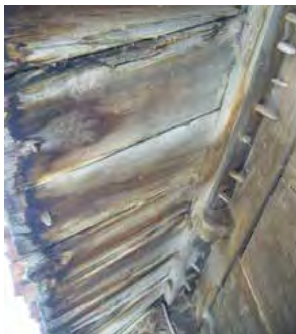
FIG. 08.060 Durmiente recto, con clavos de madera que fijan los tablones del faldón. Llamera_11 (A09_03).
