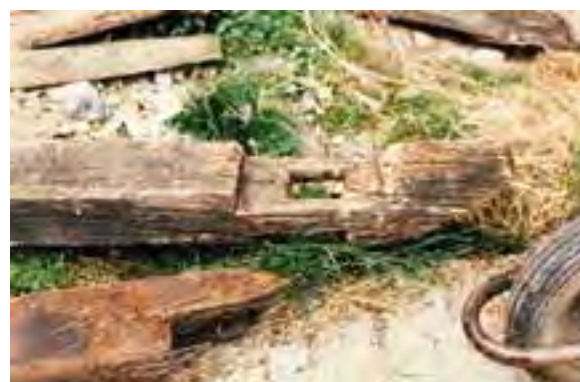
FIG. 12.28 Caja en un liño. Restauración de hórreos en el valle de Valdeón (L03), 1988-1992.
