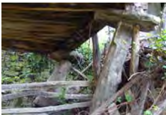
FIG. 13.09 Sistema de sustentación desplomado. Soto de Belerda_02 (A03_01).
