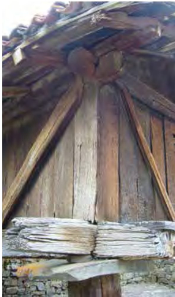
FIG. 13.53 Riostras añadidas a un hórreo sin bastidor. Valdeprado_01 (C01).
