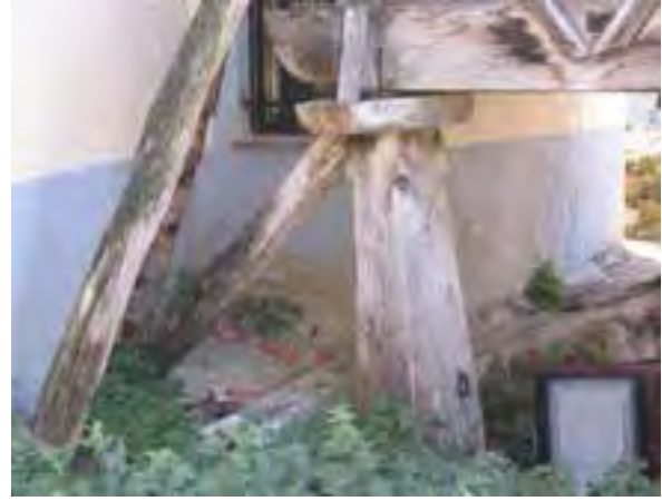
FIG. 13.07 Pegollo desplomado y apuntalado. Posada de Valdeón_05 (L03).
