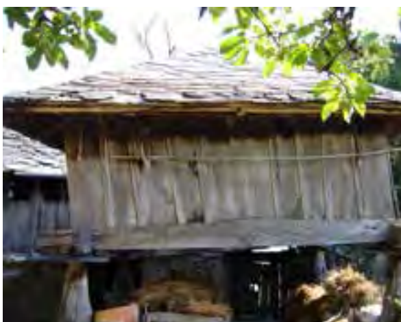
FIG. 13.38 Caja desplomada en un hórreo sin bastidor. Buso_02 (A11_02).
