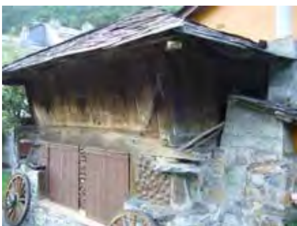
FIG. 13.30 Caja deformada. Cerredo_06 (A10).
