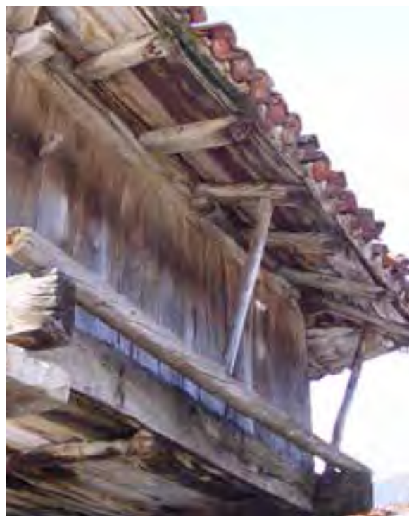
FIG. 08.087 Tentemozos aislados, desde el extremo del trabe o una estructura auxiliar. Torrestío_08 (L06).
