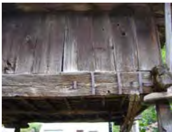
FIG. 13.19 Apósito en trabe roto. Navedo_03 (A05_01).
