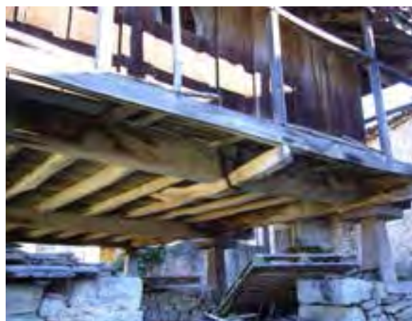
FIG. 08.122 Ménsula colgada para sustento del corredor. Corés_02 (A08_04).
