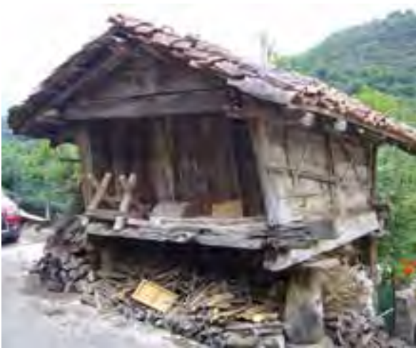
FIG. 13.33 Caja deformada de un hórreo con bastidor. Avellanedo_01 (C01).
