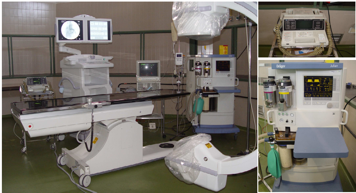
Figura 23. Quirófano y equipamientos.
