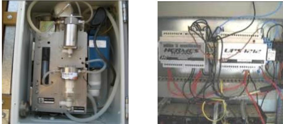
Figura 6.3.1- Sistema antiincendios. Sistema de bombeo y medición de CO (izquierda). Centralita para envío de mensajes y activación de válvula (derecha).
