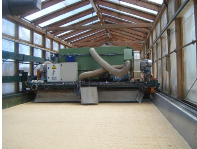
Figura 2.4.2.- Vista general de la instalación del secadero solar durante los ensayos con serrín de pino.
