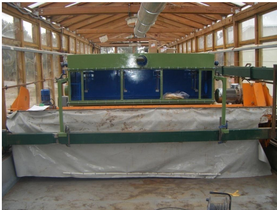
Figura 5.6.3.- Filtro de mangas acoplado sobre el bastidor del volteador con soportes recién soldados
