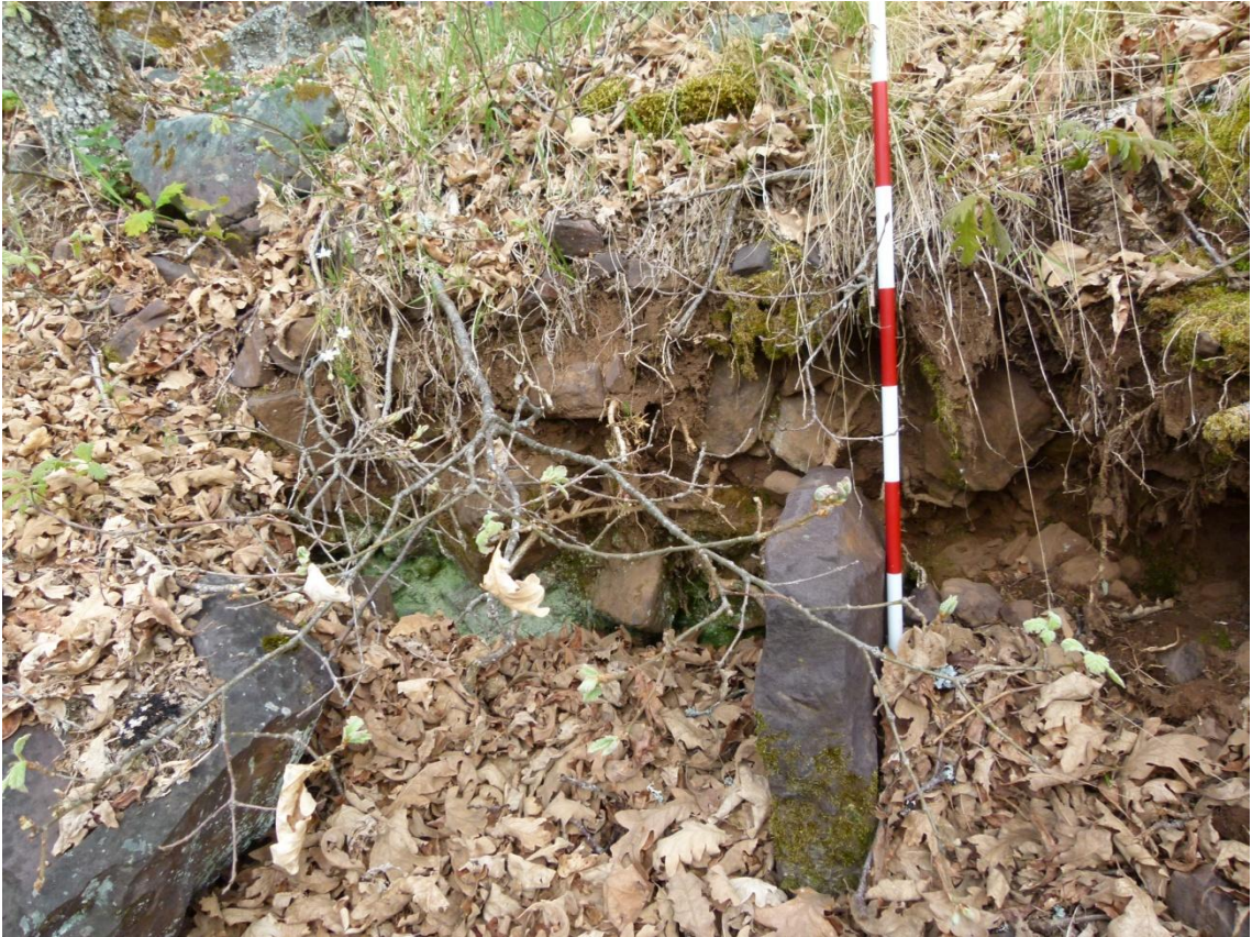
Imagen 29. Detalle de cimentación de la cabaña con el suelo colapsado.
