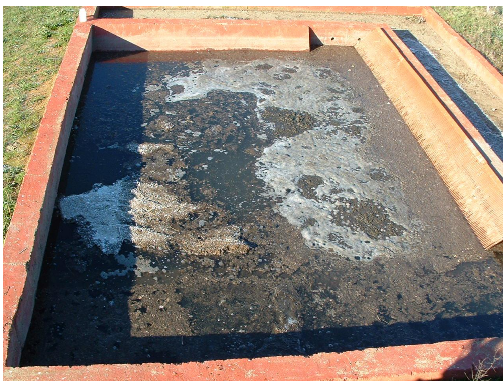
Figura 2.2. Etapa de Pretratamiento de la depuradora de tipo MJEA ® de Bustillo de Cea.
