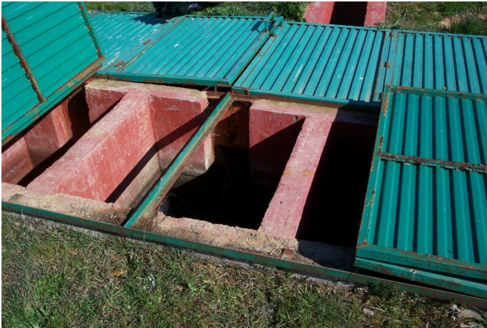
Figura 2.3. Distribuidor la depuradora de tipo MJEA ® de Bustillo de Cea.
