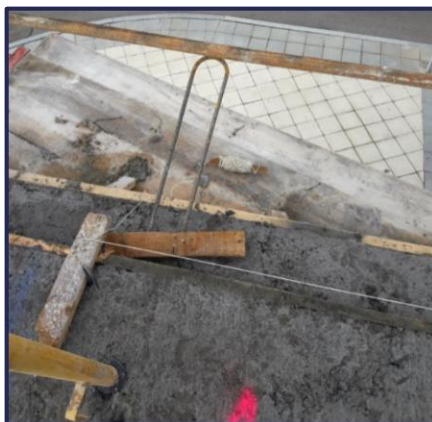
Fotografía 35. Horcas. Fuente: Propia
