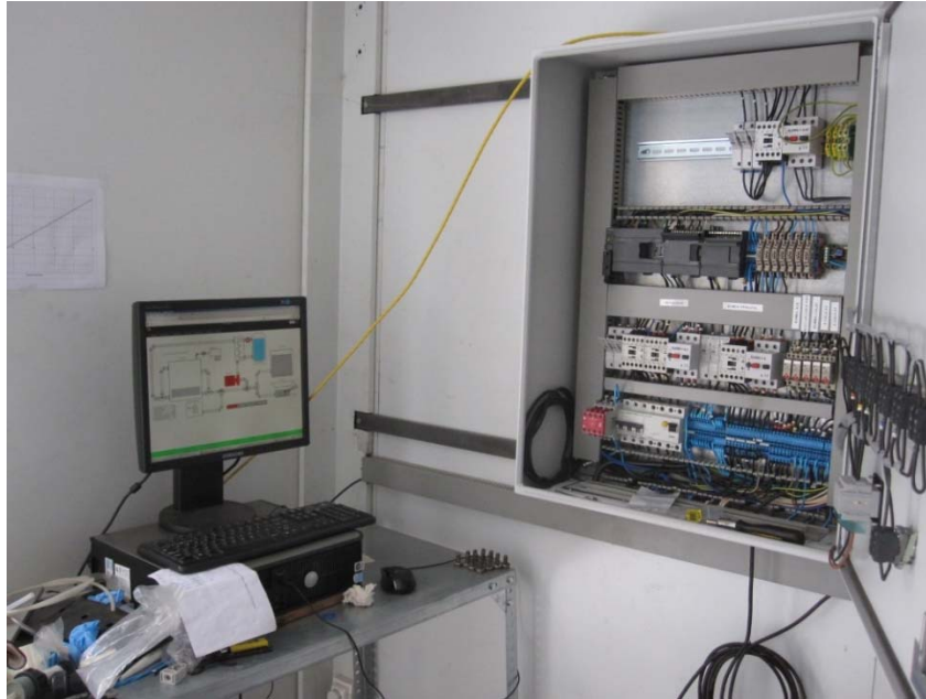
Figura 6.7 Unidad de control ubicada en el interior de la caseta de control
