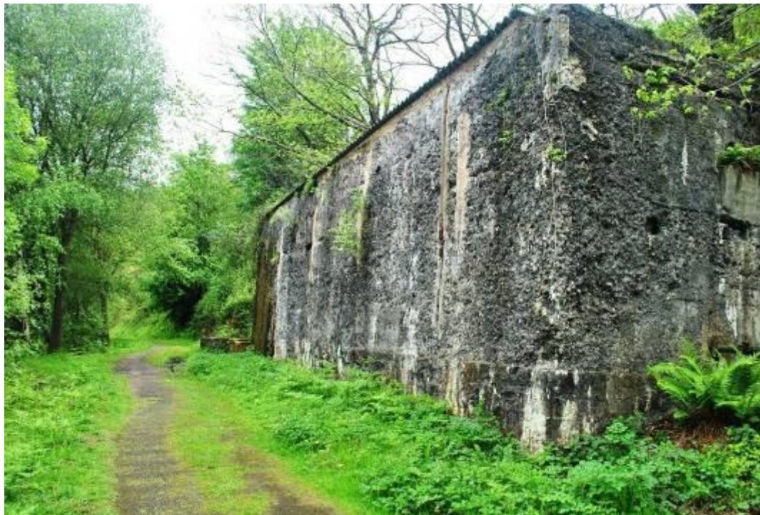
Ilustración 20. Restos actuales del depósito de aguas de La Pereda. Fuente: Fotografía cortesía de la Asociación Cultural Los Averinos
