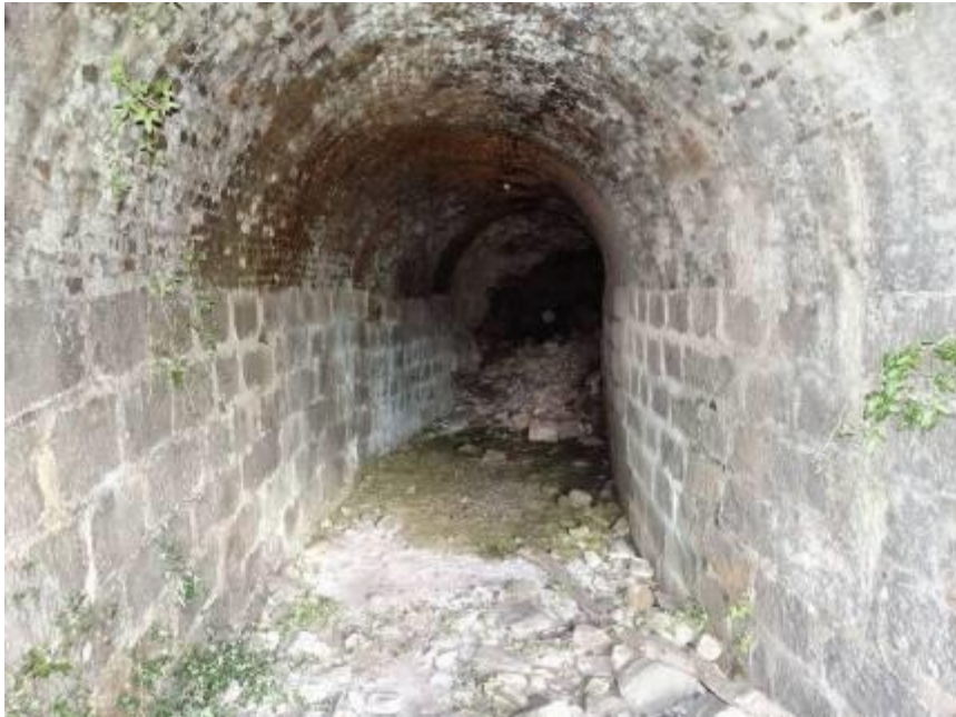
Ilustración 54. Interior Sur del túnel de la Boqueriza, nivel 456, piso 8º. (Morcín). Fotografía José Luis Cabo Sariego.
