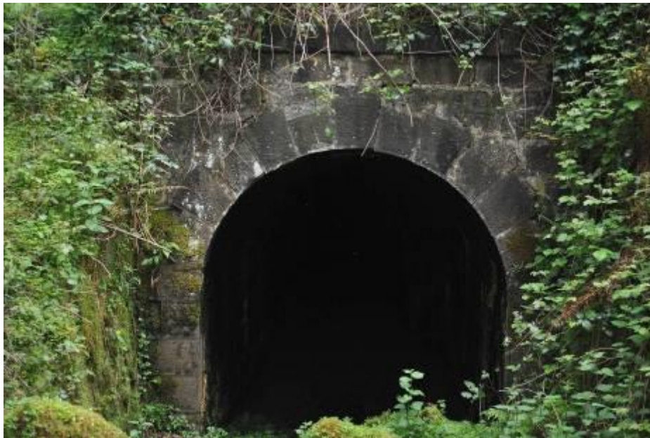
Ilustración 55. Boca Norte del túnel de la Boqueriza. (Loredo) Fotografía de la Asociación Cultural Los Averinos.
