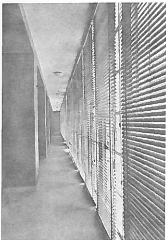
Fig. 7. Ambulatorio Hermanos Larrucea, pasillo interior exclusivo del personal sanitario entre el muro cortina y las salas de consultas (espacio volado), recién terminado sobre 1955, Marcide. Fuente: INP.
