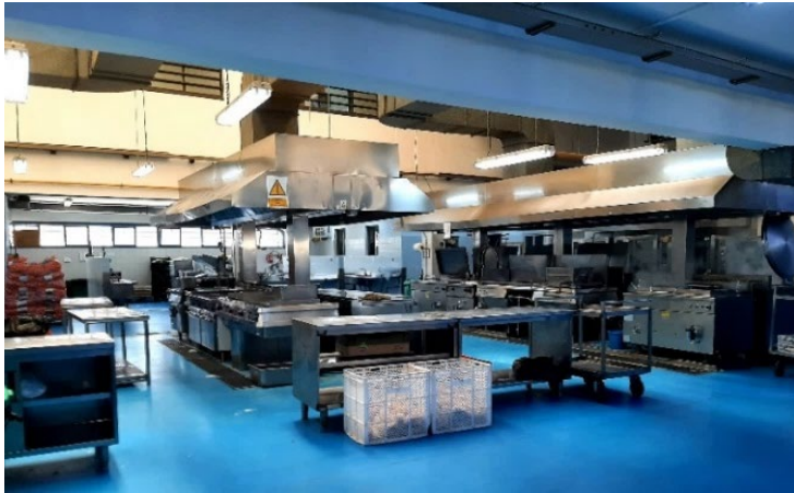
Foto: Cedida por el CP León. Instalaciones de cocina.
