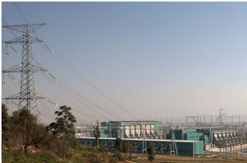
Figura 6 Detalle de la línea Jinping-Sunan (China) y una subestación
