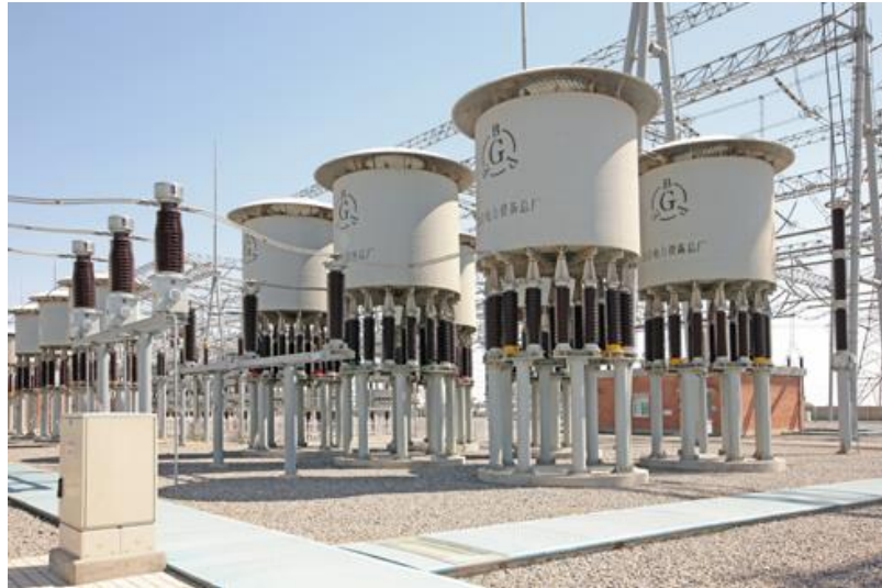
Figura 13 Reactancia de suavizado en subestación. Fuente: China daily
