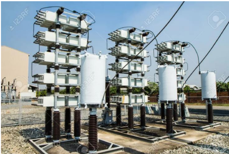
Figura 12 Bancada de condensadores
