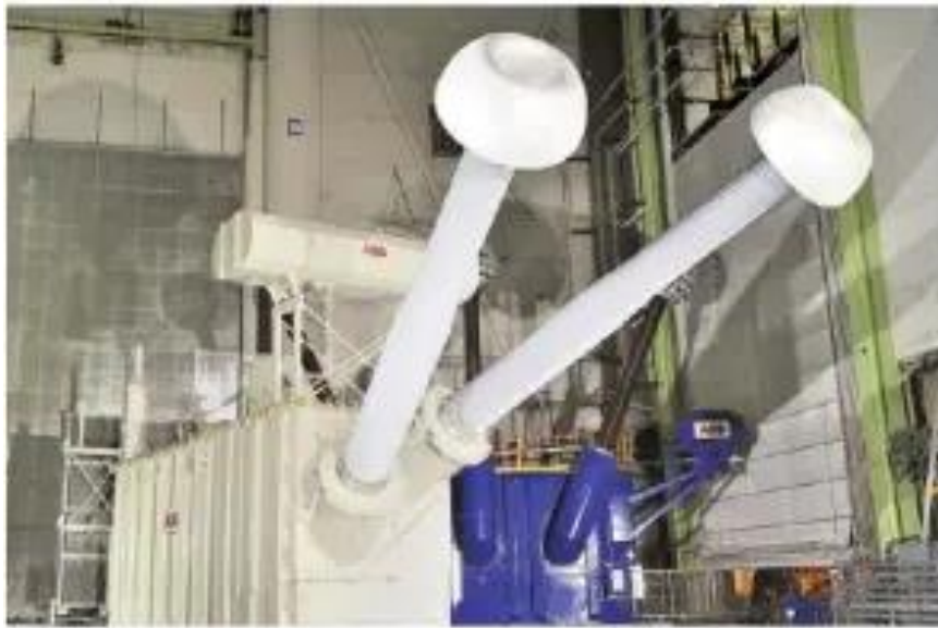
Figura 8 Transformador de conversión. Fuente: WordPress
