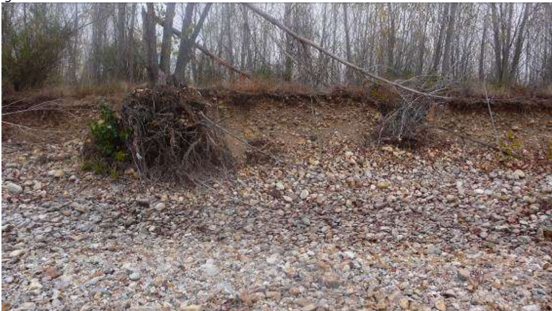
Fotografía 24066-GEO-055-3: Erosión de las márgenes no cohesivas de la terraza inferior, en la margen derecha, por el canal principal, con descalce y caída de chopos.
