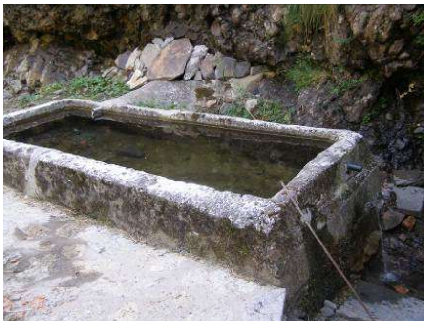
Fotografía 24020-HID-001-1: Estado actual de la fuente.
