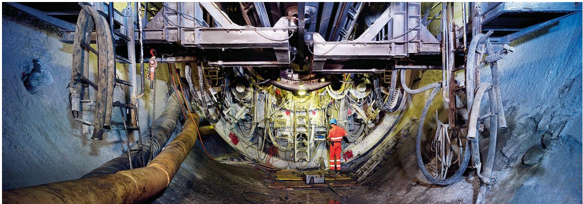
Figura 4.3.- Vista posterior de cabeza de corte de una tuneladora.
