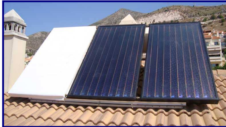
Figura 8.7: Colectores solares tapados
