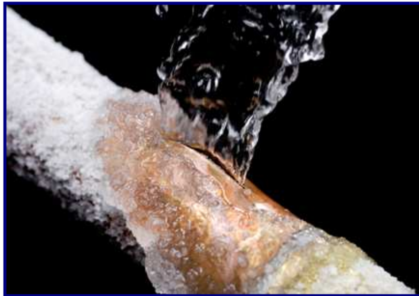
Figura 4.18: Reventón de una tubería de cobre por congelación del agua ( www.idealgroupuk.co.uk )
