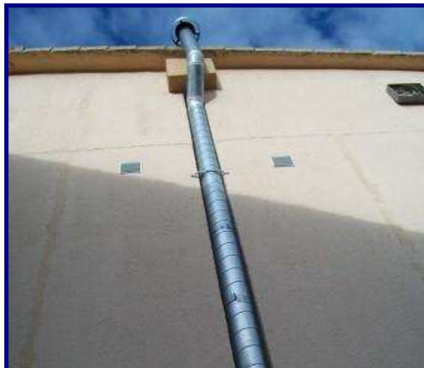
Figura 3.30: Chimenea de calefacción para evacuación de humos
