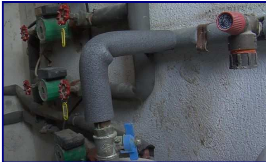
Figura 4.11: Ejemplo de aislamiento en una tubería
