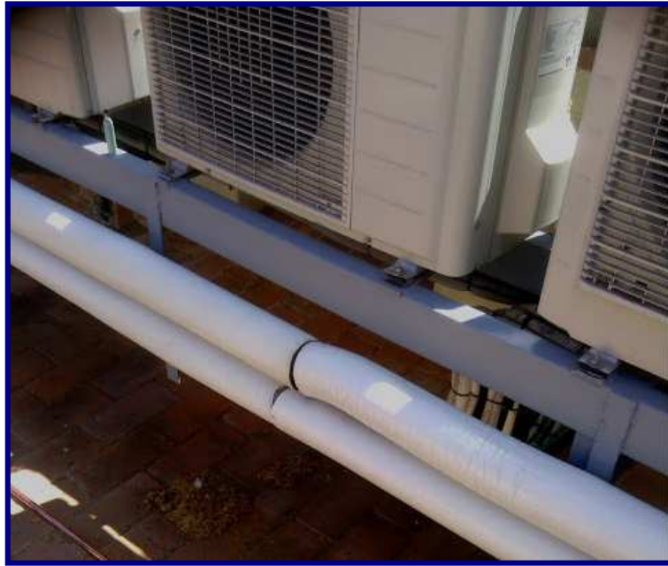
Figura 8.17: Tubería de exterior con recubrimiento
