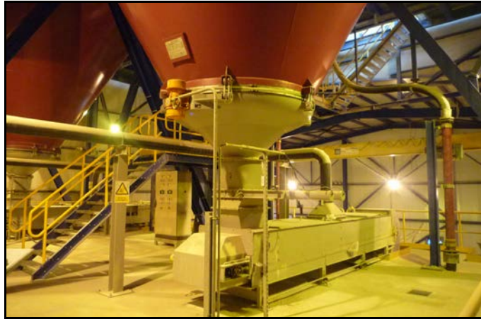
Figura 5.10. Silos de Almacenamiento de Caliza.
