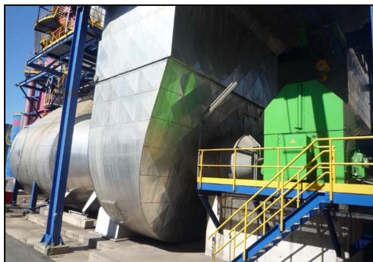
Figura 5.21. Ventilador de Refuerzo (BUF).
