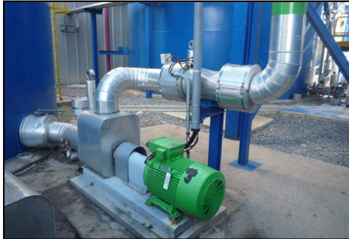
Figura 5.49. Bomba de Agua de Emergencia al Absorbedor.
