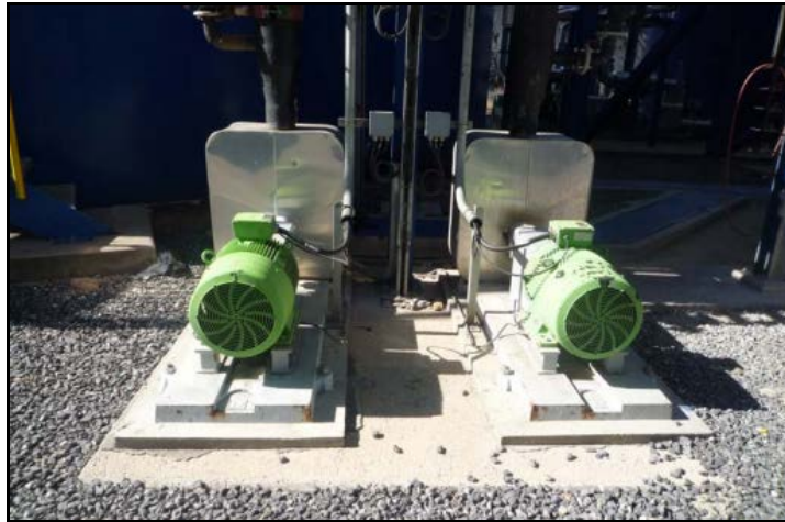
Figura 5.48. Bombas de Agua de Proceso.
