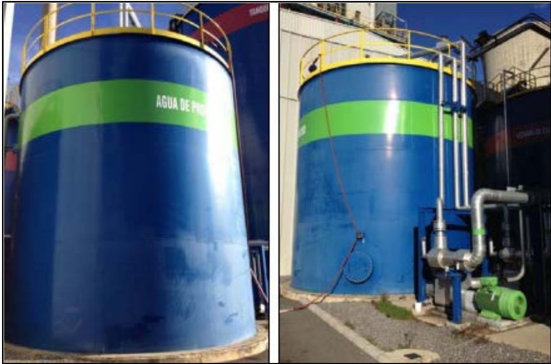
Figura 5.47. Tanque de Agua de Proceso.
