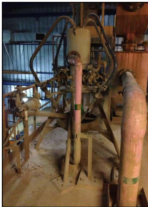
Figura 5.35. Hidrociclón de Agua Residual.
