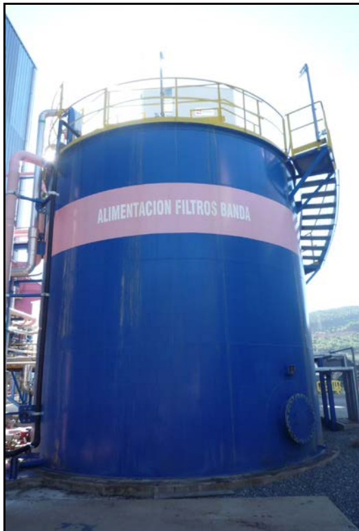
Figura 5.37. Tanque de Alimentación Filtros Banda.
