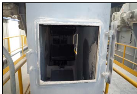
Figura 5.8. Detalle de cangilón en el Elevador de Cangilones.
