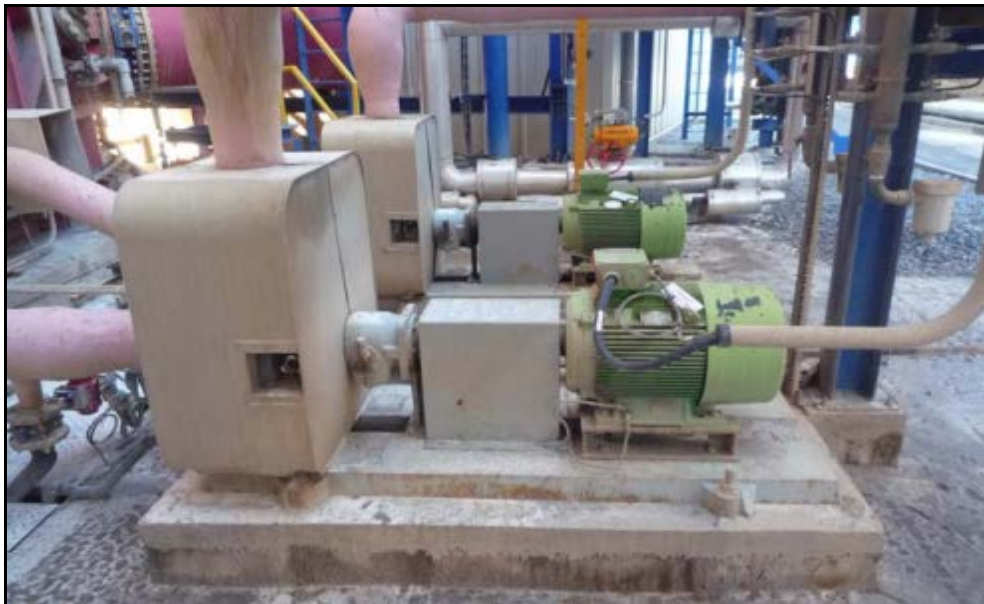
Figura 5.36. Bombas de Purga de Yeso.
