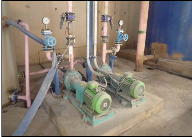
Figura 5.41. Bombas de Lavado de Tela.
