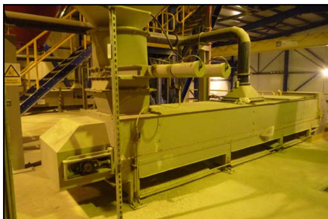
Figura 5.11. Cintas Transportadoras de Dosificación.
