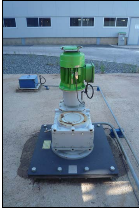
Figura 5.52. Agitador del Pozo de Drenaje del Área de Secado de Yeso.
