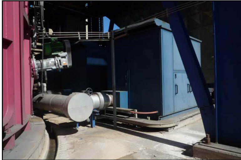
Figura 5.29. Soplante de Aire de Oxidación.
