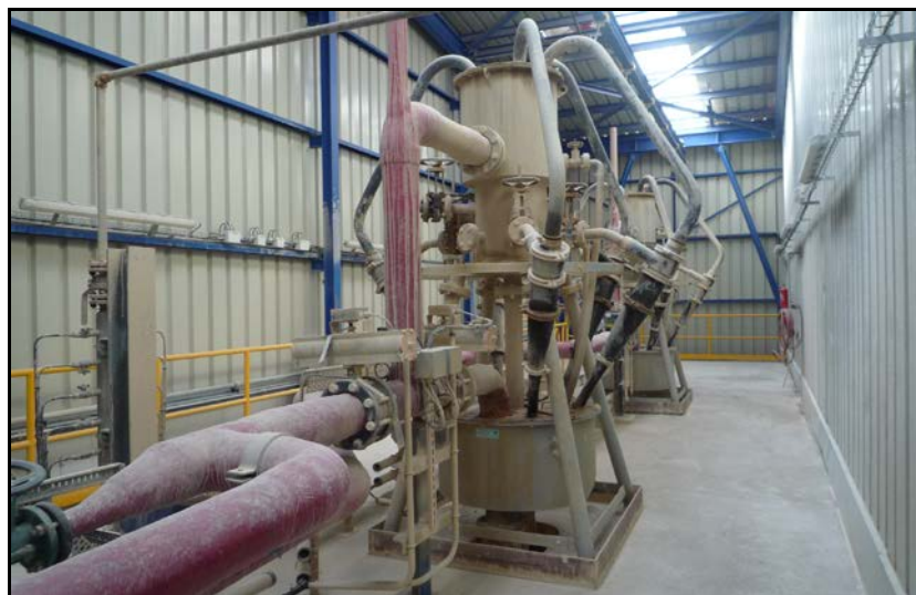
Figura 5.16. Hidrociclones de Caliza.
