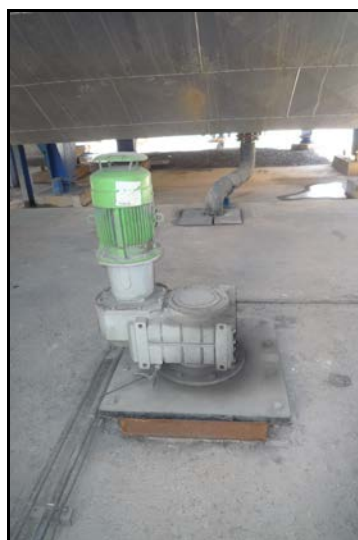
Figura 5.51. Agitador del Pozo de Drenaje del Absorbedor.
