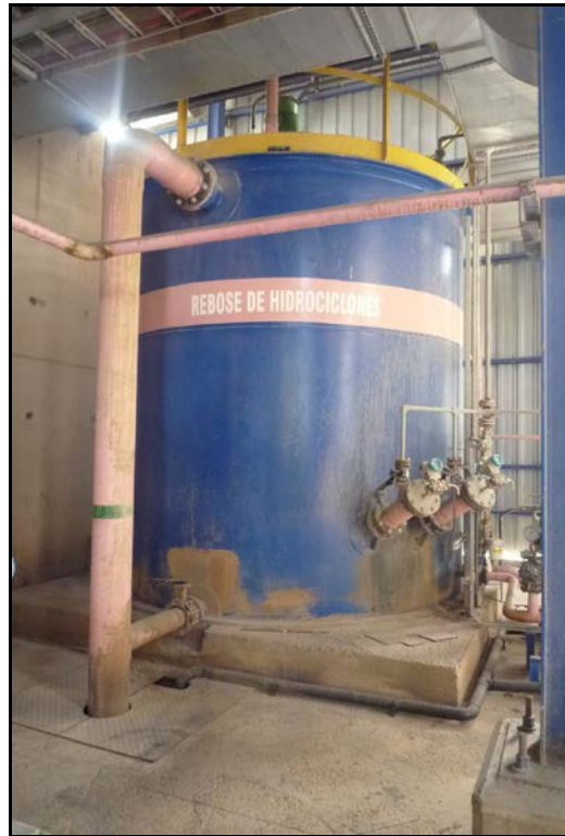
Figura 5.32. Tanque de Rebose de Hidrociclones.
