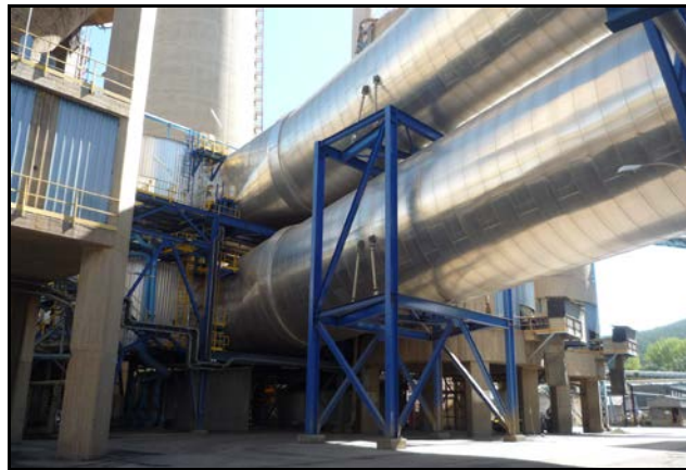
Figura 5.18. Conductos de gases.
