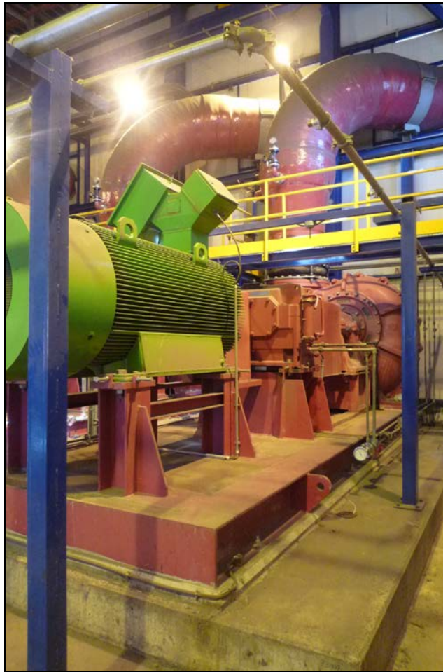
Figura 5.28. Bomba de Recirculación del Absorbedor.
