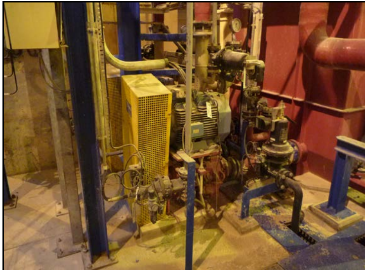
Figura 5.15. Bomba de Molienda de Caliza.
