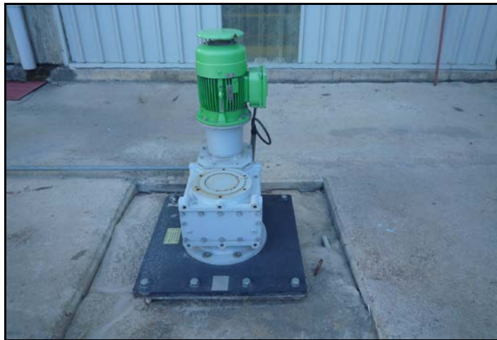
Figura 5.53. Agitador del Pozo de Drenaje del Área de Caliza.
