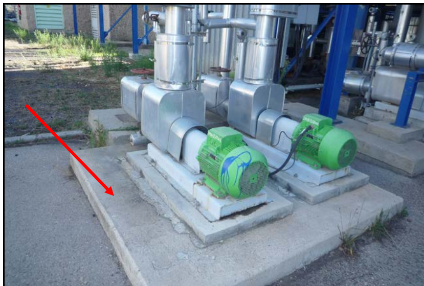
Figura 5.66. Ubicación de la nueva Bomba de Agua de Refrigeración.
