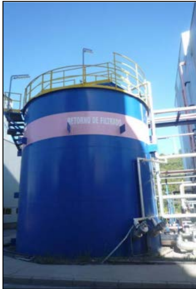
Figura 5.30. Tanque de Retorno de Filtrado.
