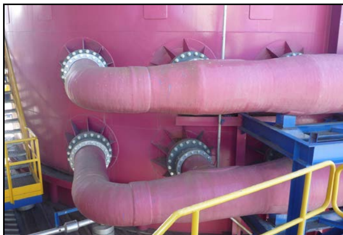
Figura 5.24. Entrada de lechada de caliza en el Absorbedor.
