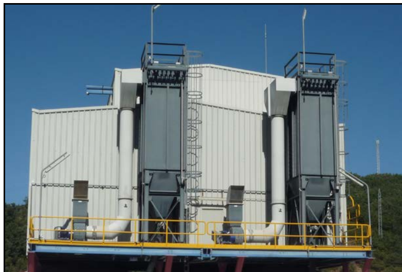
Figura 5.12. Equipos de filtrado/captación de polvo.
