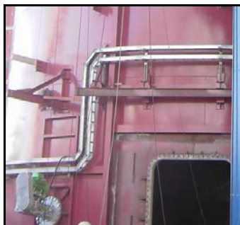
Figura 5.27. Boca de hombre en el Absorbedor.
