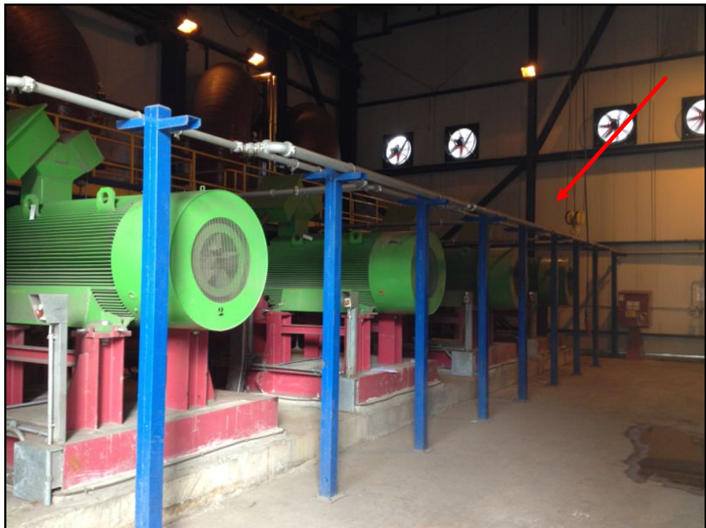
Figura 5.65. Ubicación de la 5ª Bomba de Recirculación.
