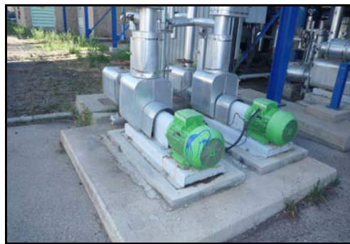
Figura 5.54. Bombas de Agua de Refrigeración.
