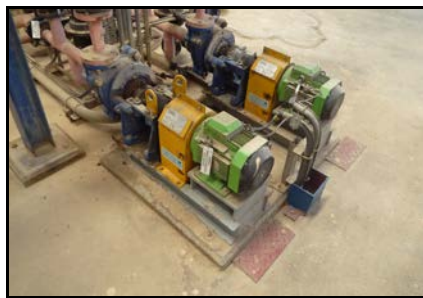
Figura 5.33. Bombas del Tanque de Distribución.
