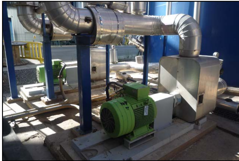
Figura 5.31. Bombas de Retorno de Filtrado.
