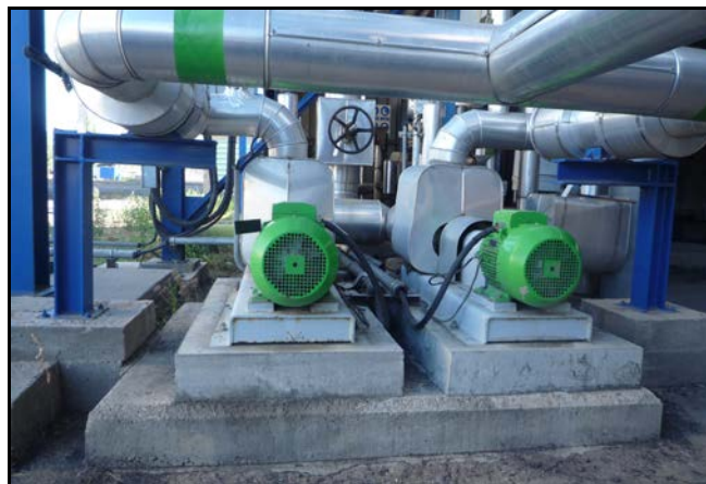
Figura 5.46. Bombas de Agua Bruta.
