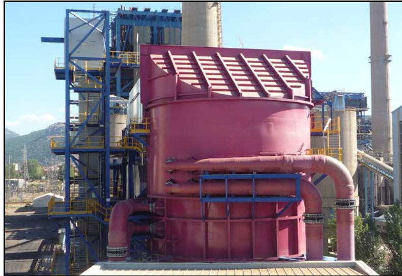
Figura 5.23. Parte superior del Absorbedor de gases de combustión.
