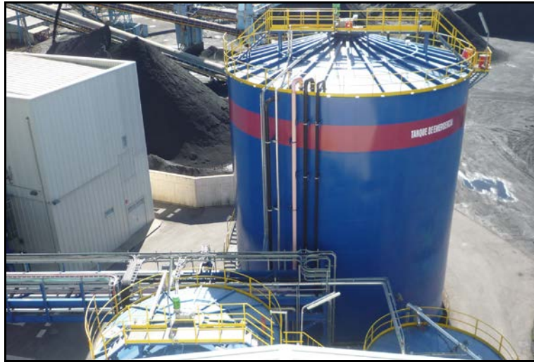
Figura 5.50. Tanque de Emergencia.
