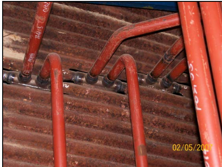
Figura 7.27. Conductos que salen de la caldera hacia la unidad de mezcla.
