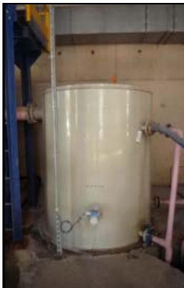
Figura 5.42. Tanque de Lavado de Tela.
