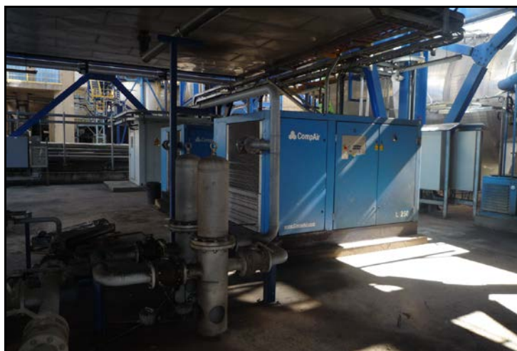
Figura 5.55. Compresores y Prefiltros.
