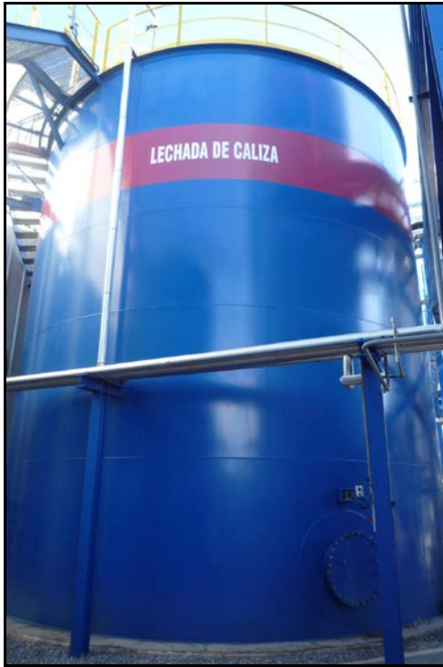
Figura 5.17. Tanque de Almacenamiento de Lechada de Caliza.
