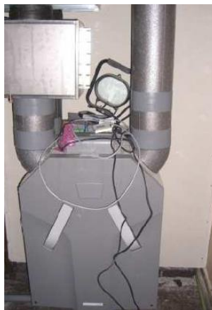
Figura 6.9 Recuperador de calor.
