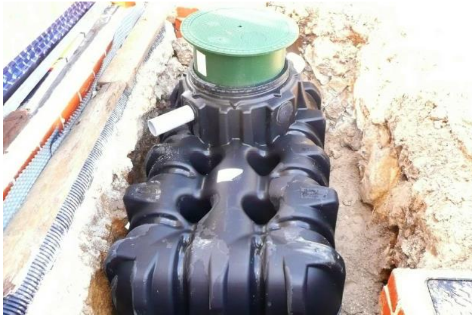
Figura 6.12 Depósito de 1.500 L.
