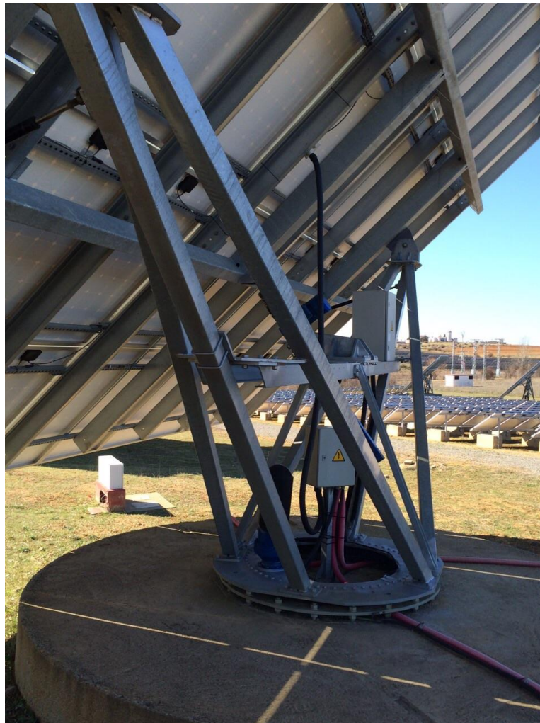
Figura 5.1 – Seguidor solar de Mecasolar® instalado en Golpejar de la Sobarriba (León)
