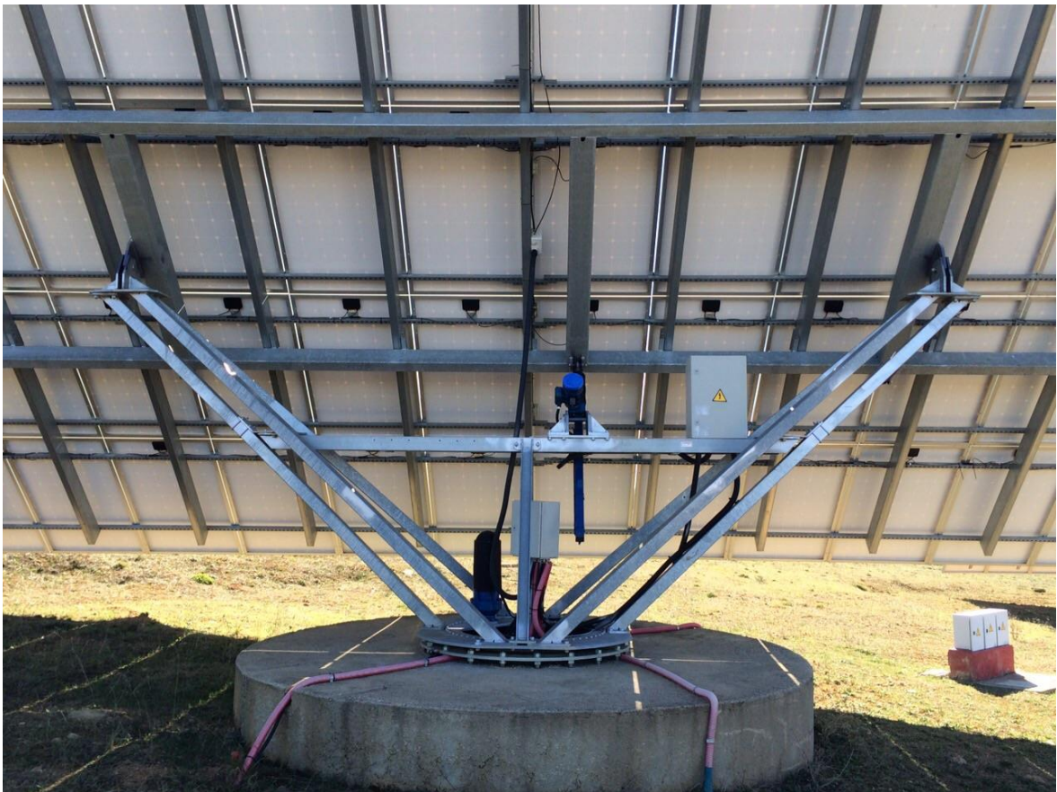
Figura 5.2 – Seguidor solar instalado en Golpejar de la Sobarriba, de la compañía Mecasolar®
