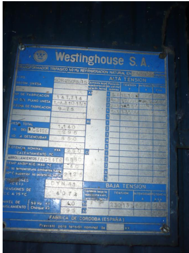
Figura 110.12.-Placa de características del antiguo transformador.
