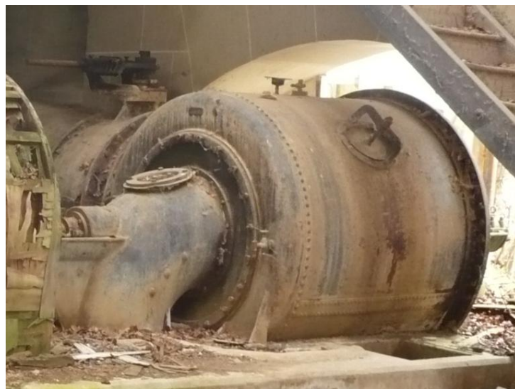
Figura 5.2.- Turbina Francis de la central hidroeléctrica de Calahorra de Ribas.
