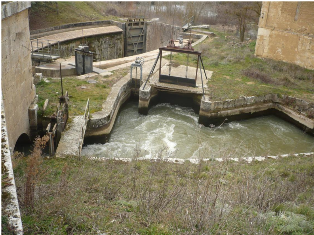
Figura 110.8.-Toma de agua y cámara de carga.
