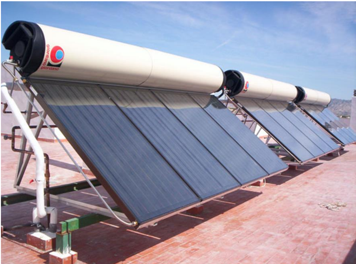
Figura 1.5.- Configuración de paneles termo solares.
