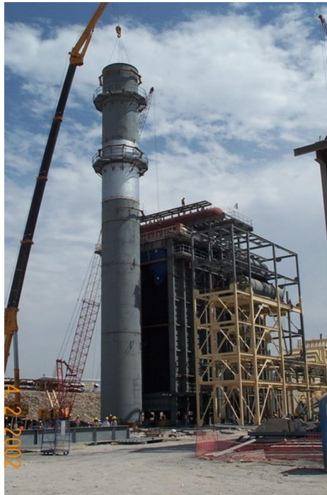
Figura 3.10.- Chimenea fabricada con planchas de acero.
