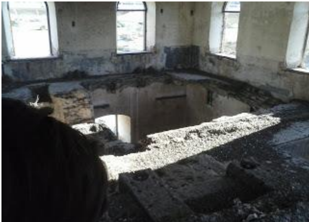
Figura 0.24 Agujero en tercer piso del molino
