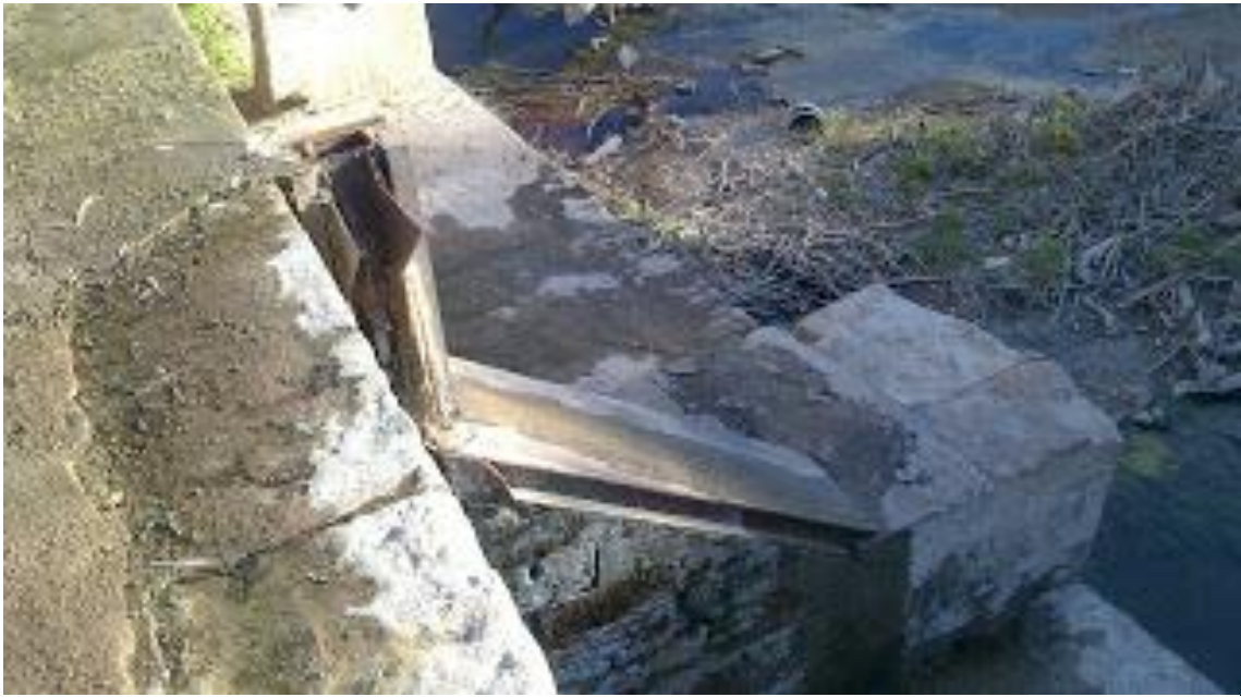
Figura 0.11 Desagüe desde parte superior
