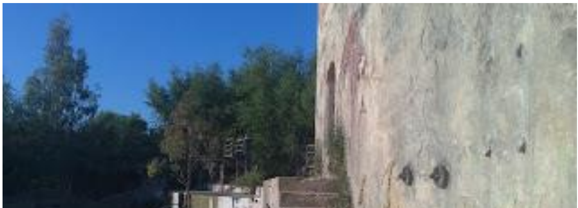
Figura 0.13 Deterioro de fachada exterior lateral
