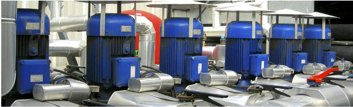
Figura 5.9.- Bombas de rotor seco en paralelo
