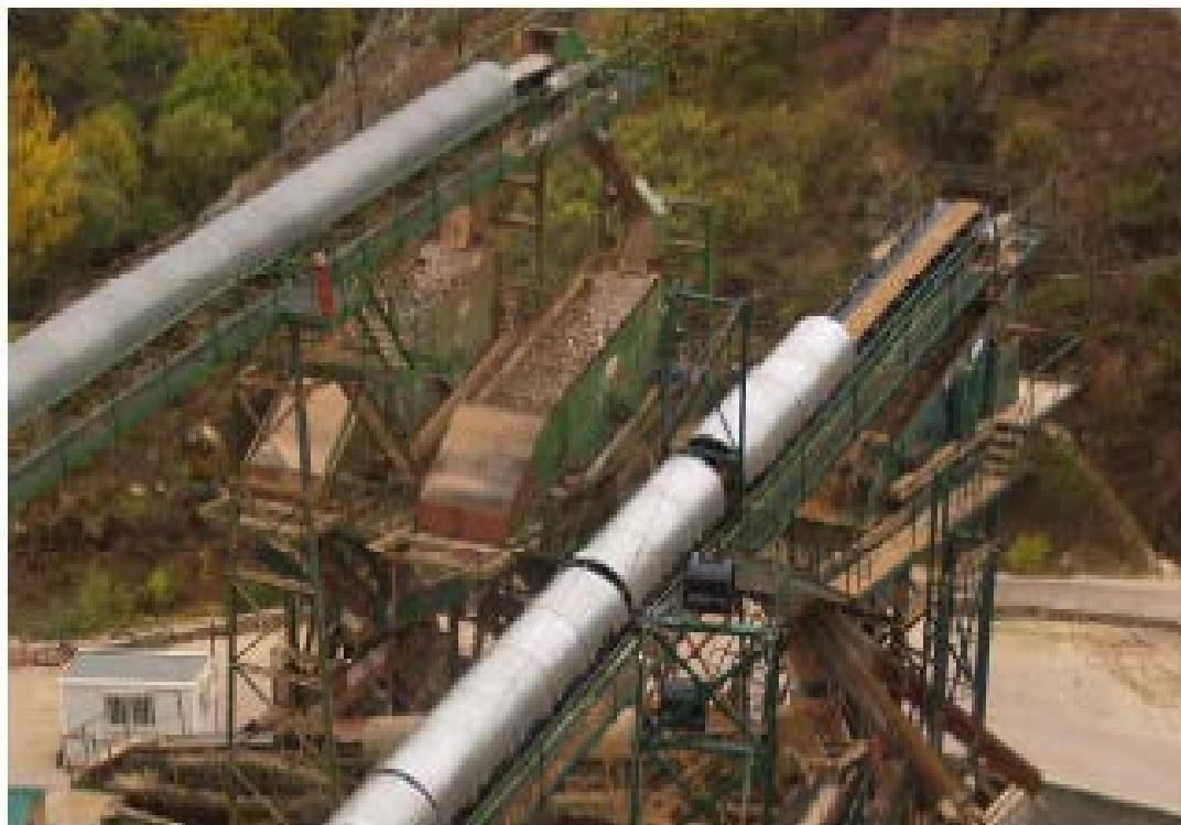
Foto 5.1.2.- Conjunto de cribas.
