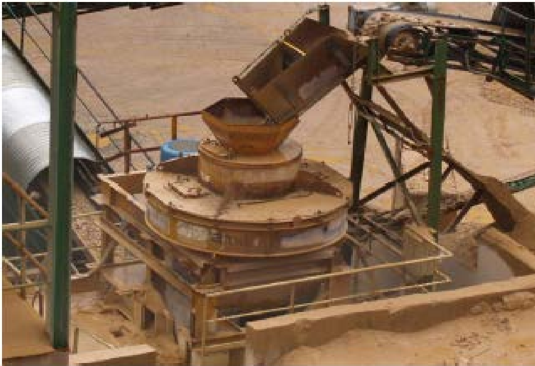
Foto 5.1.1.- Molino secundario rotopactor BARMAC para eliminación de aristas.
