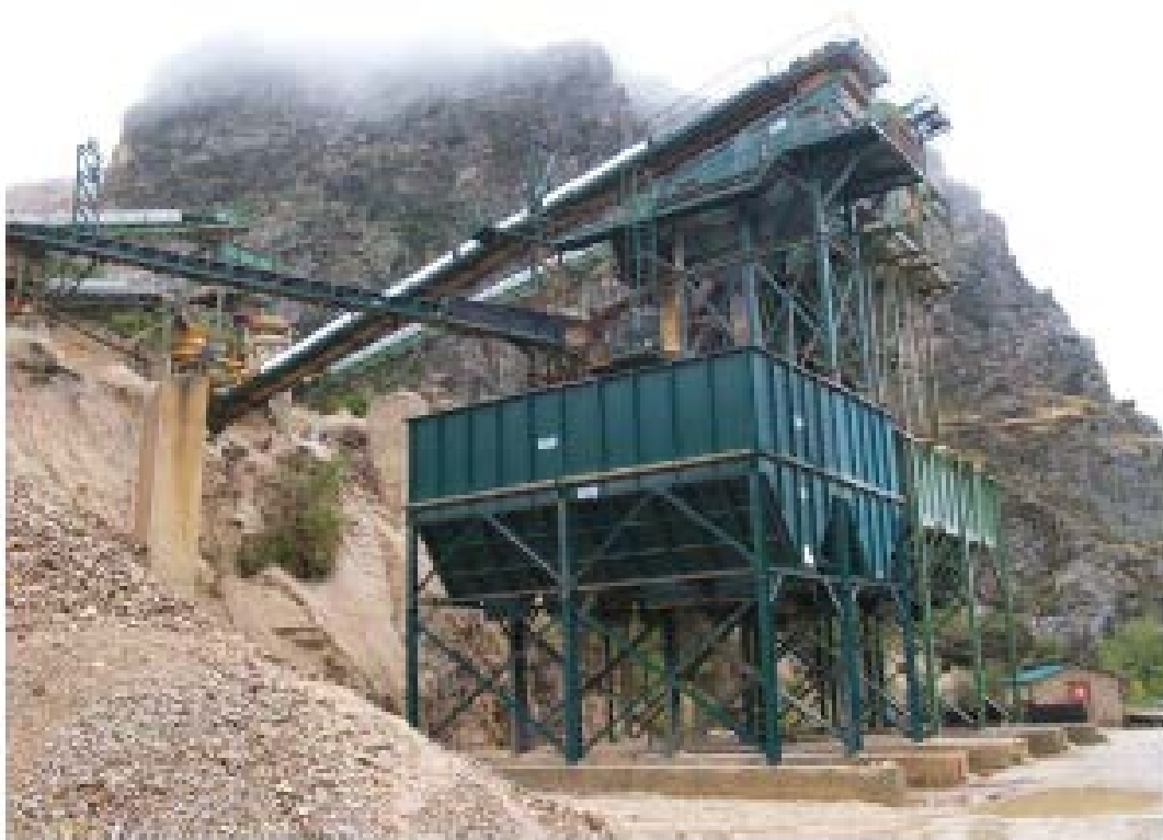
Foto 5.1.3.- Vista general de las tolvas, cintas, y detrás, los molinos del secundario.
