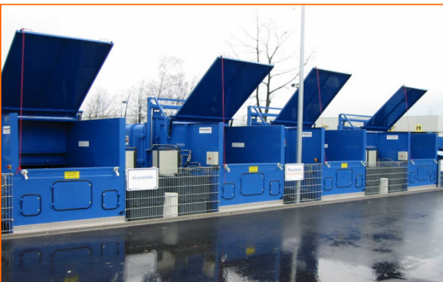
Planta de reciclaje con compactadores ST-SEL-TS
