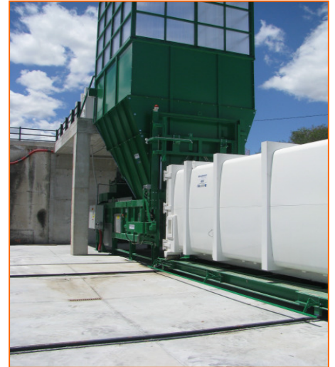
Estación con sistema automático de acoplamiento y cambio de contenedores
