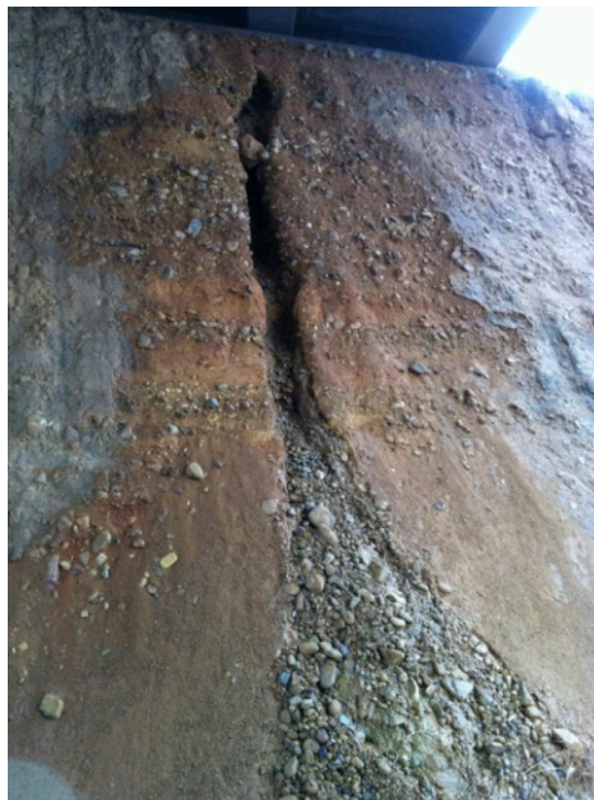
Fig. 1.27. Cárcava bajo un viaducto de la N-630 (León).
