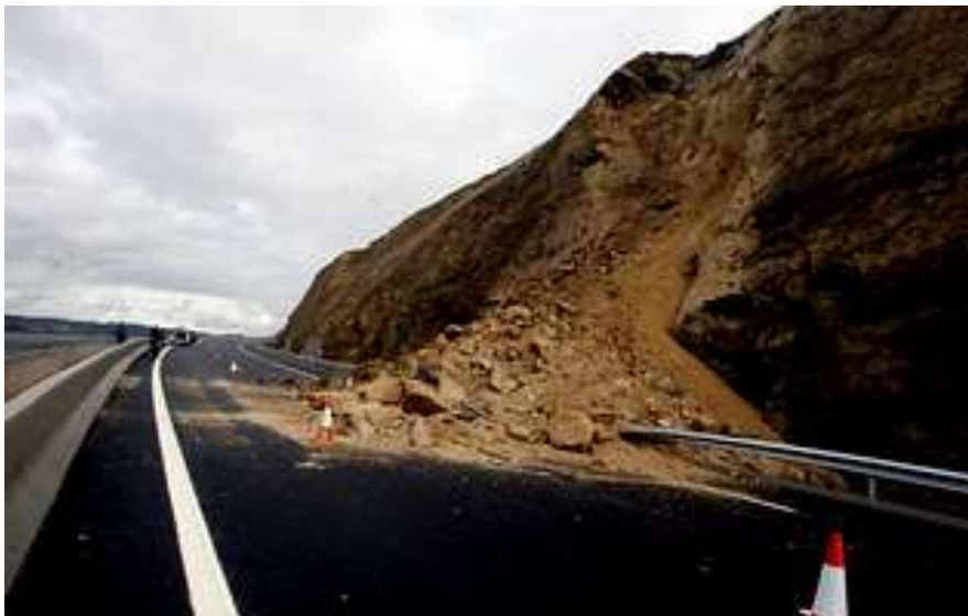
Fig. 1.10. Desprendimiento del talud en desmonte en la AG-53 (ARCA, 2010).
