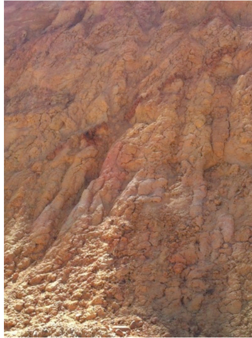
Fig. 1.26. Surcos en un talud de la carretera N-630 (León).
