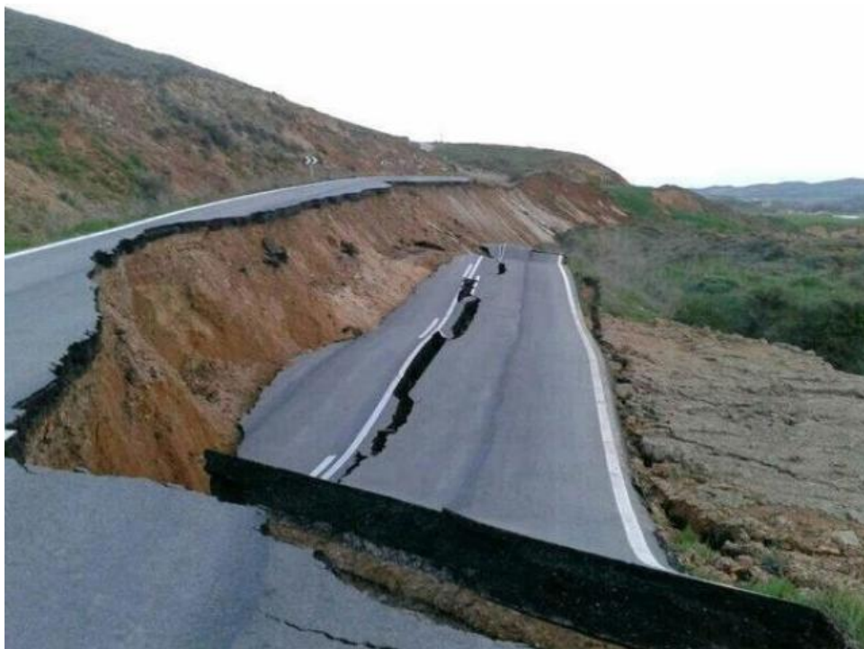
Fig. 1.19. Deslizamiento de terraplén en carretera de Jaén (Lolyr, 2010).
