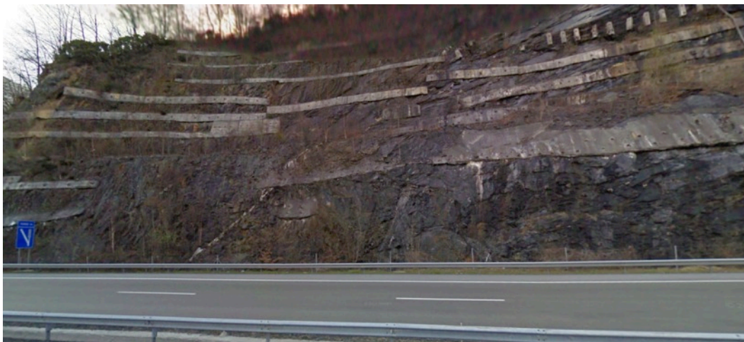
Fig. 1.11. Pantallas y anclajes metálicos en un talud de la A-66 (León-Asturias).
