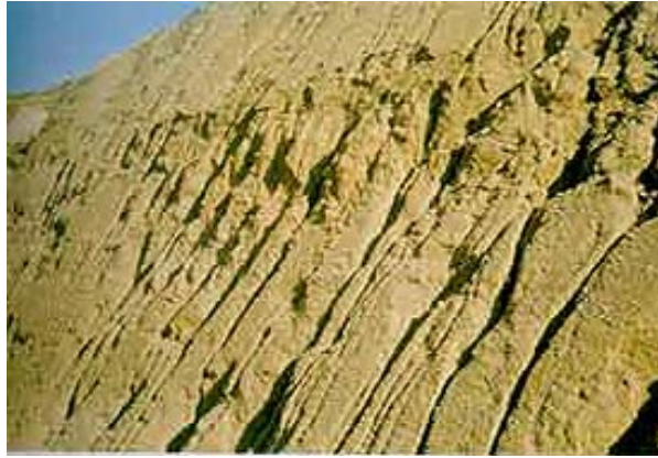
Fig. 1.14. Arrastre de áridos en el desmonte de una carretera (Ruíz, 1999).
