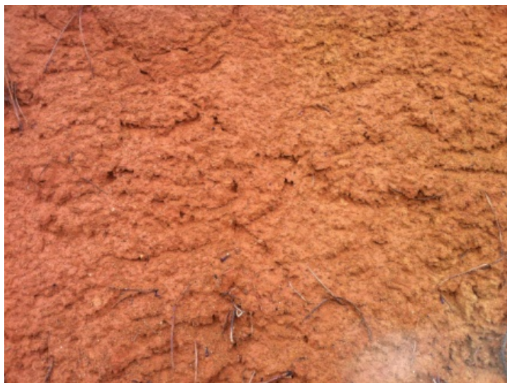
Fig. 1.24. Splash erosion en un talud de la carretera N-630 (León).
