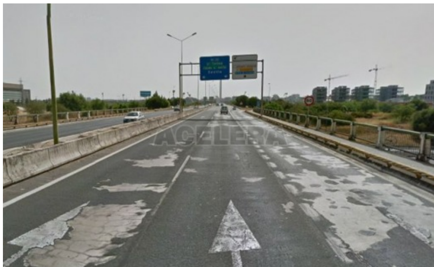
Fig. 1.16. Ejemplo de baches en una carretera debido al ineficiente drenaje (La-razon, 2014)
