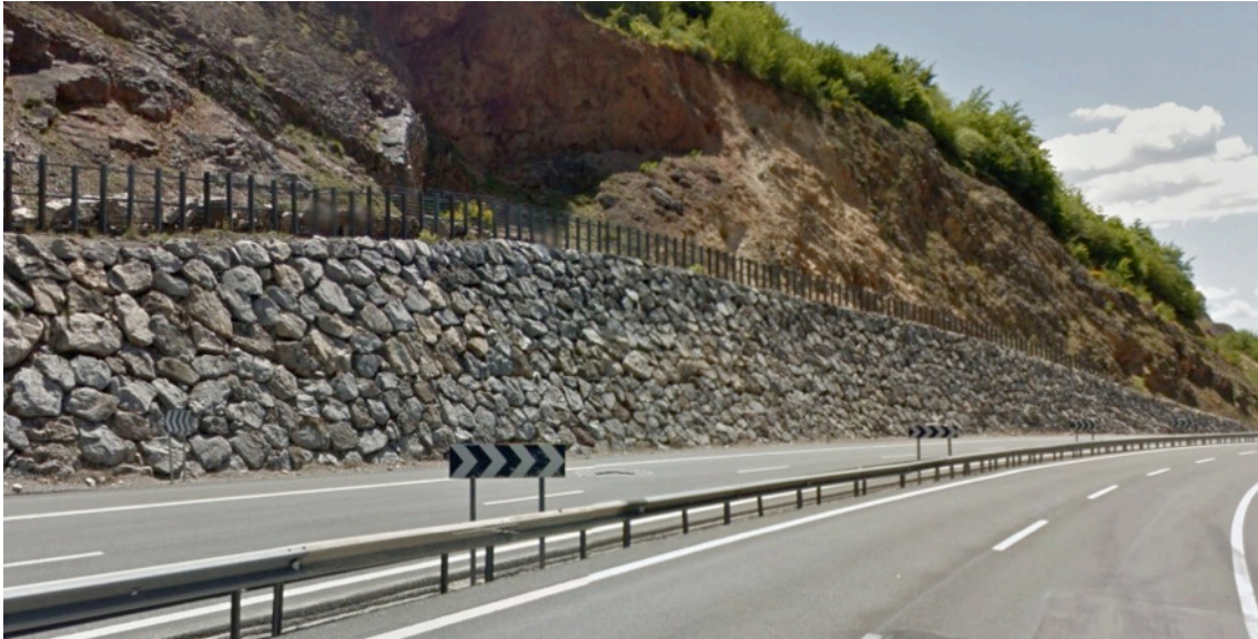
Fig. 1.12. Muro de contención de escollera en un talud de la A-66 (León-Asturias).
