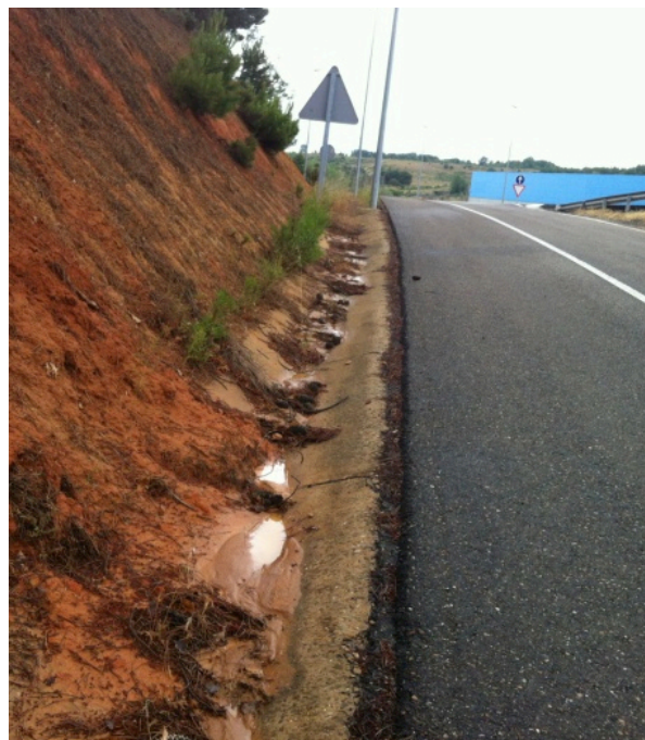
Fig. 1.25. Erosión laminar en un talud de la carretera N-630 (León).
