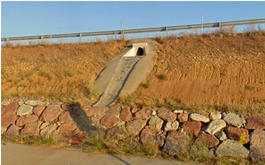
Fig. 1.13. Muro de escollera y cuneta de descarga para desagüe de un talud de la LE-30 (León).
