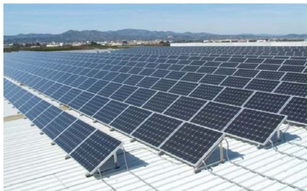
Figura 2.31. Placas fotovoltaicas para producción solar. Fuente: HelioSolar
