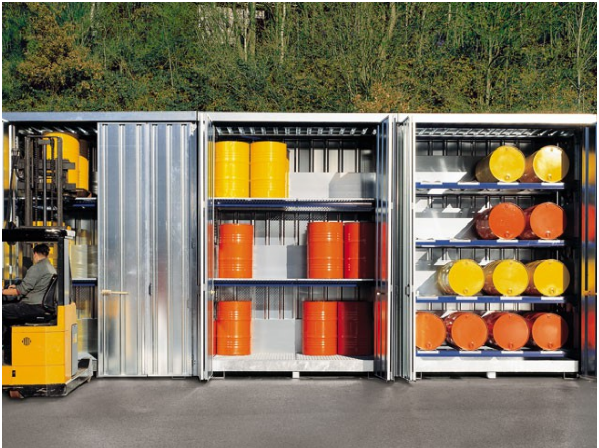
Figura 8.3.- Almacenamiento de productos peligrosos.
