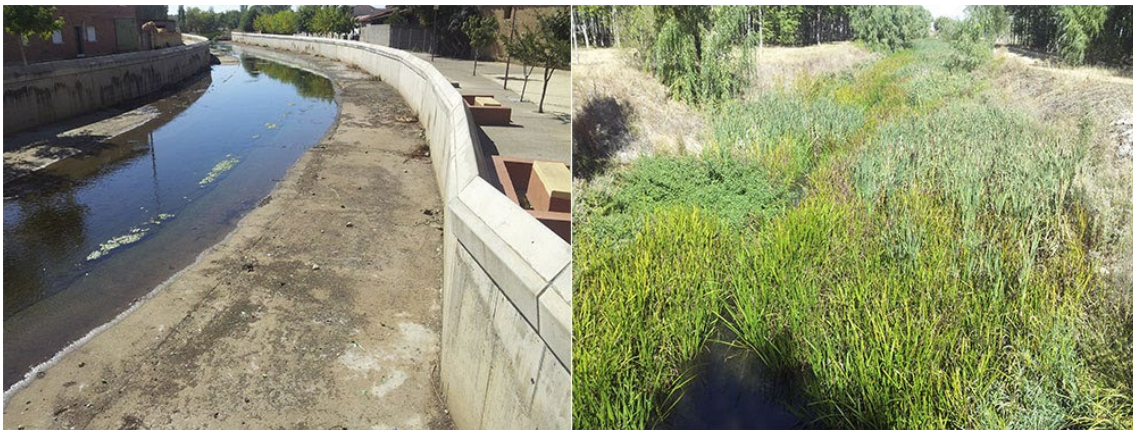
Fotografía 5.1 Encauzamiento en el río Jamuz y crecimiento de carrizal en el cauce.
