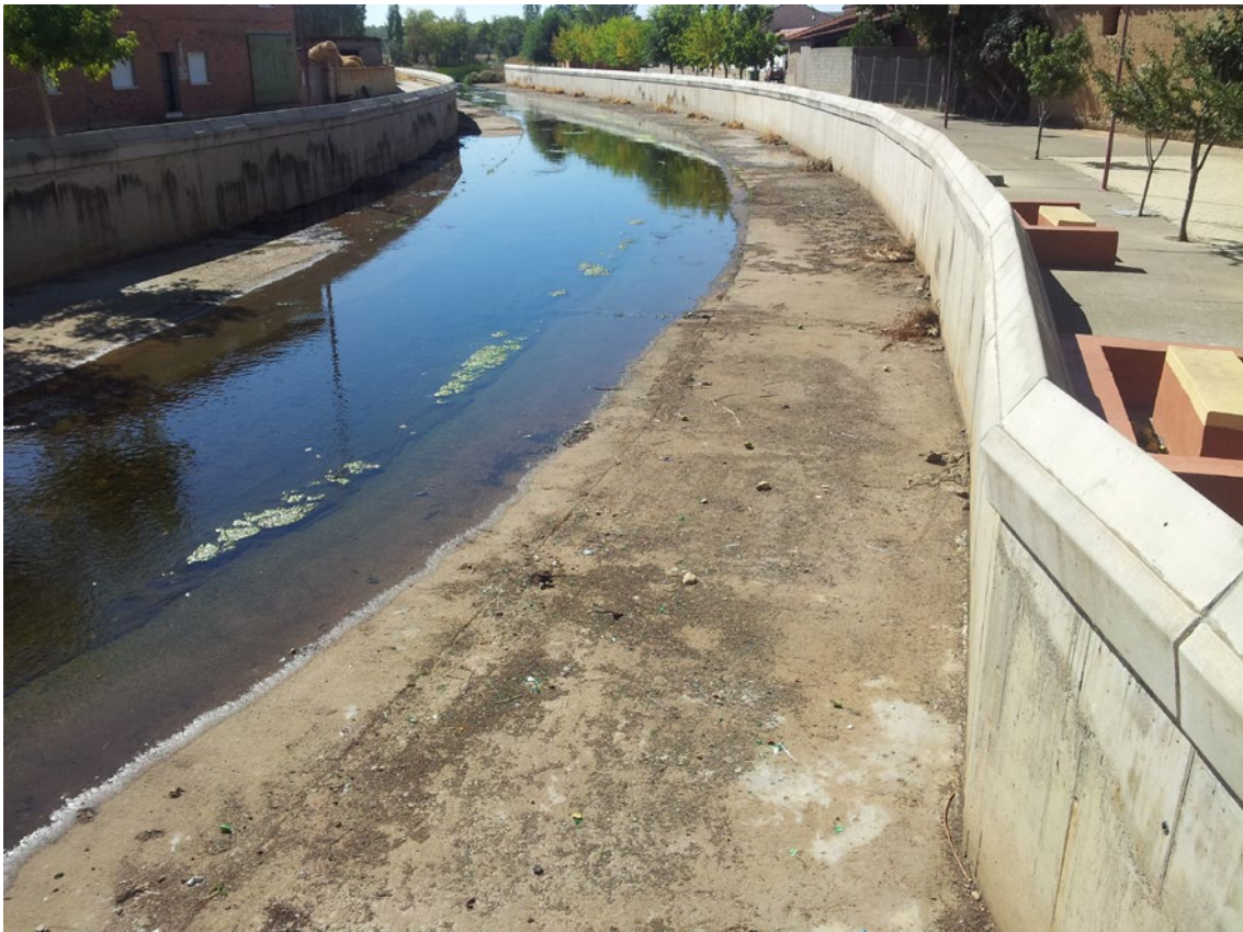
Fotografía 1.3. Río Jamuz a su paso por Quintana del Marco, encauzado con escollera de hormigón.
