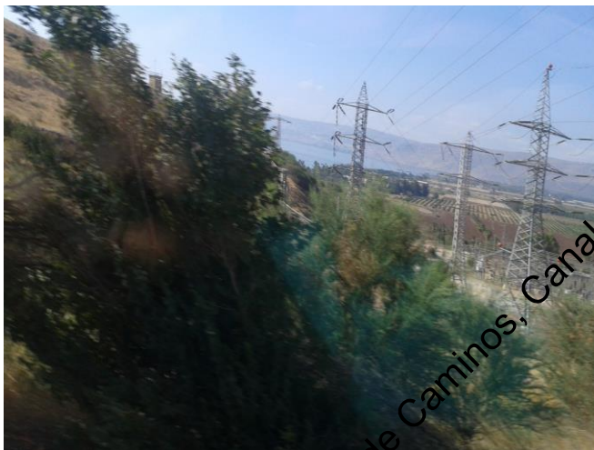
Figura 2. Subestación del bombeo desde el lago de Tiberíades al Acueducto Nacional Israelí.
